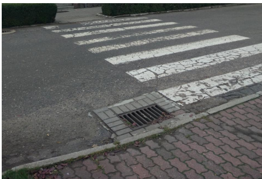
Rys. nr 3. Stan nawierzchni na ul. Sikorskiego w Słońsku.
