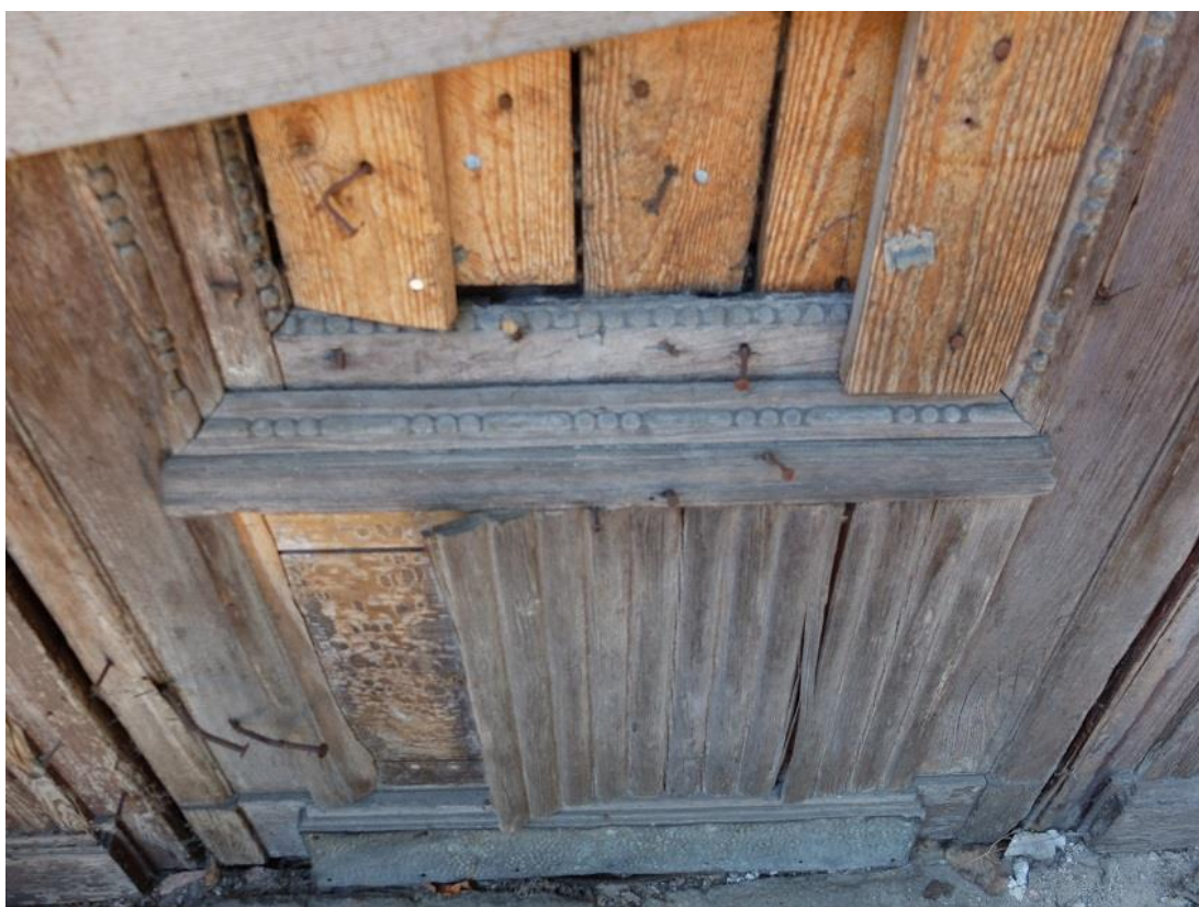
Fragmenty drzwi w wejściu do kamienicy – obecny stan zachowania
