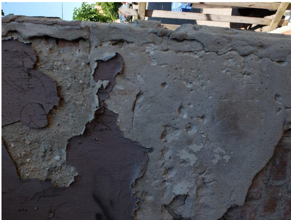
Fragment elewacji frontowej, ościeże wejścia do kamienic – widoczne znaczne zniszczenia tynków i powłok malarskich
