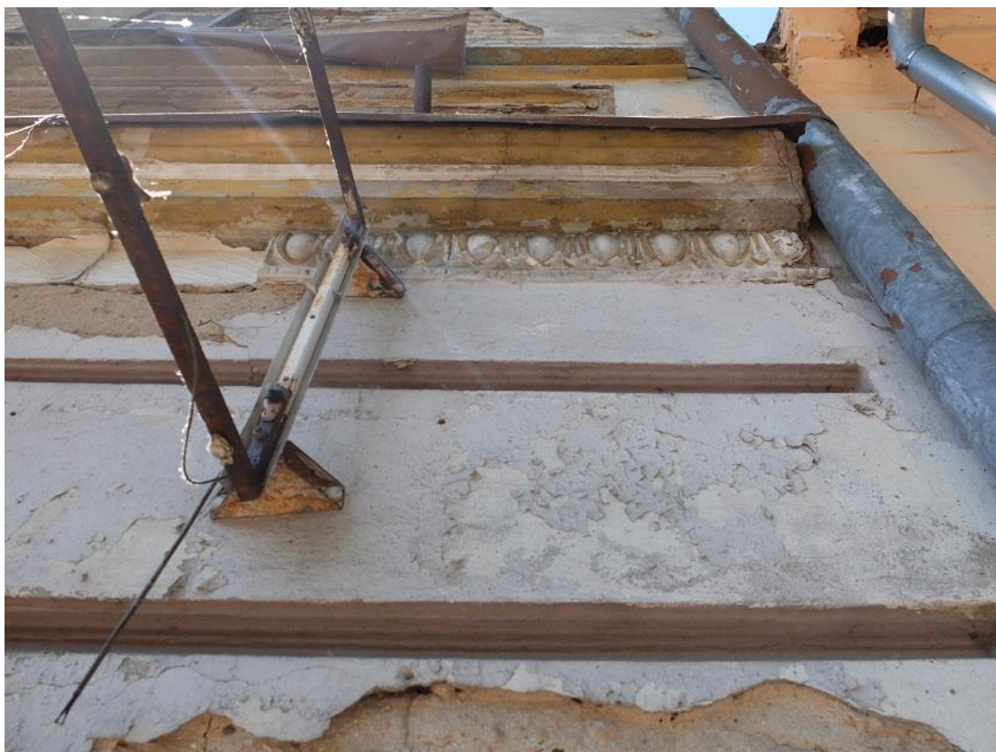
Fragmenty elewacji frontowej – obecny stan zachowania; widoczne wtórne elementy konstrukcji szyldu zamontowane na elewacji, zniszczona stolarka okienna oraz znaczne ubytki wystroju tynkarskiego i sztukatorskiego
