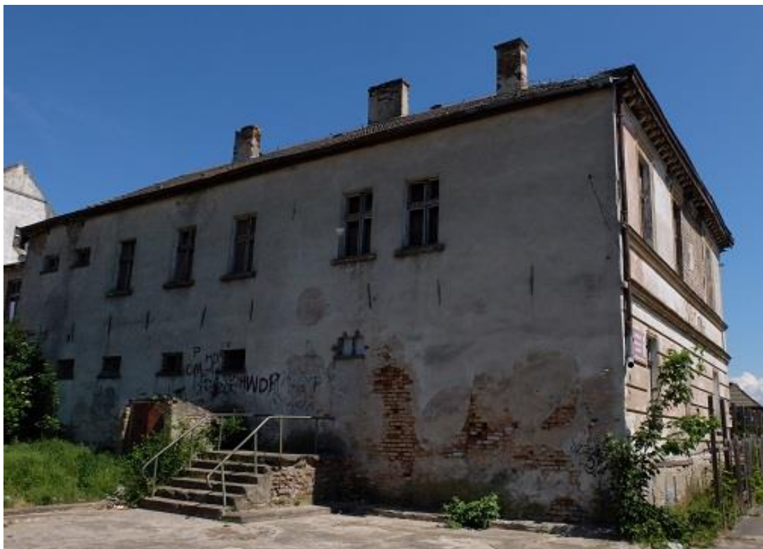
Stan zachowania elewacji kamienicy, czerwiec 2018 r.
