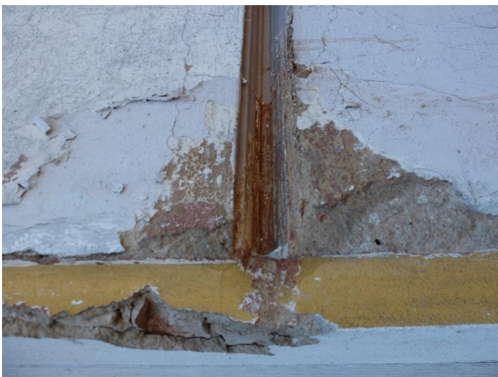
Fragment elewacji frontowej – w miejscach uszkodzeń tynków i złuszczonej wtórnych powłok malarskich widoczne pierwotne warstwy malarskie
