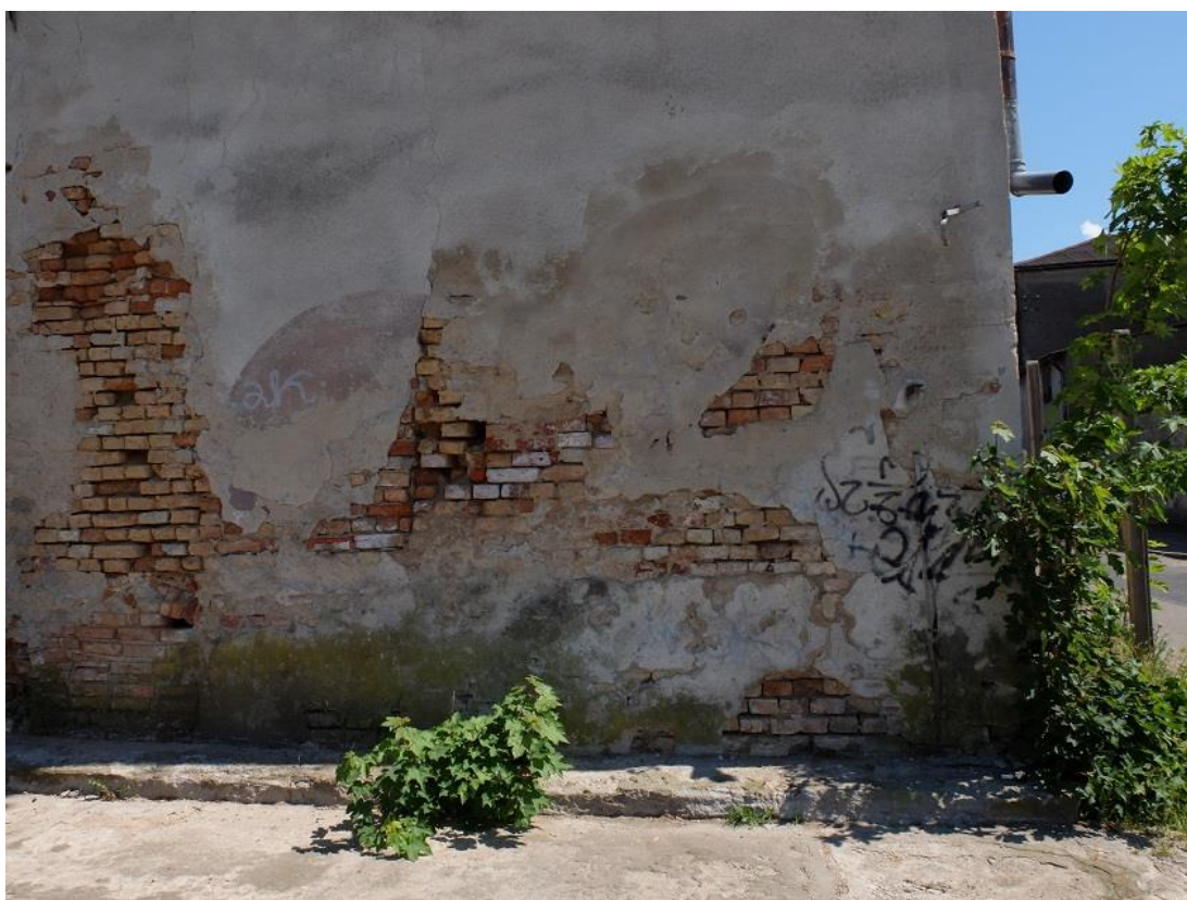
Stan zachowania elewacji zachodniej (tylnej) – widoczne znaczne zniszczenia tynków, zabrudzenia na powierzchni ścian i zniszczona stolarka okienna
