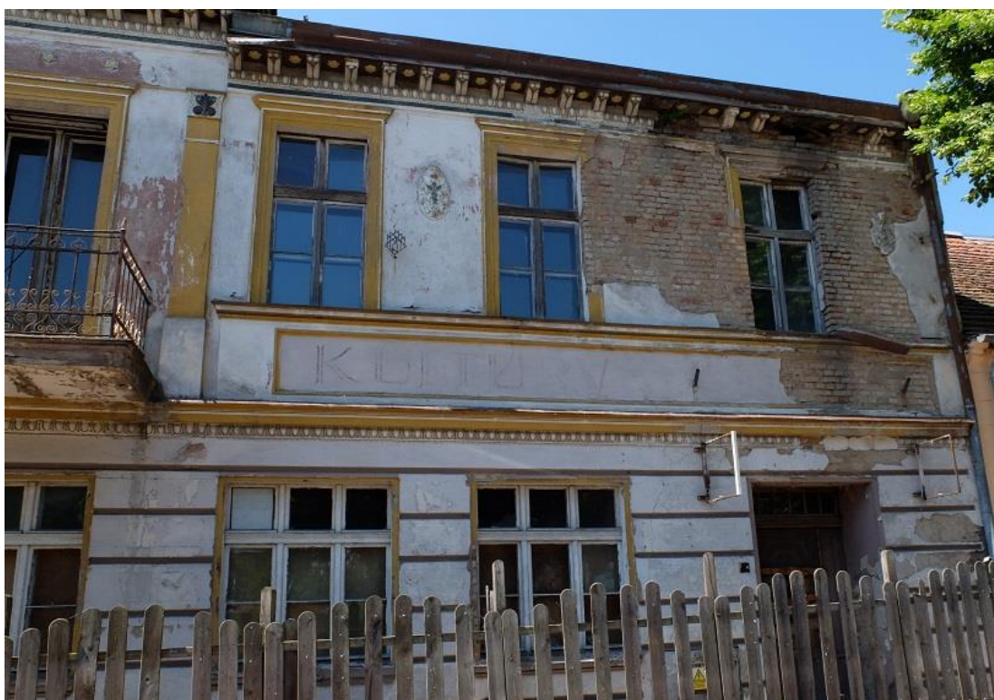
Fragmenty elewacji frontowej – obecny stan zachowania; widoczne znaczne ubytki wystroju tynkarskiego i sztukatorskiego, zniszczona stolarka okienna, uszkodzona płyta balkonowa i skorodowana balustrada balkonu
