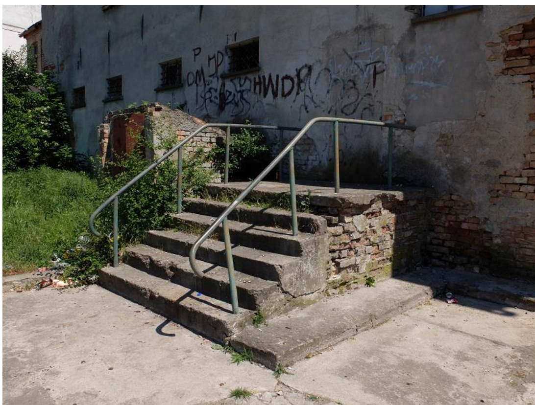
Stan zachowania elewacji zachodniej (tylnej) – widoczne znaczne zniszczenia tynków, zabrudzenia na powierzchni ścian i wtórne schody
