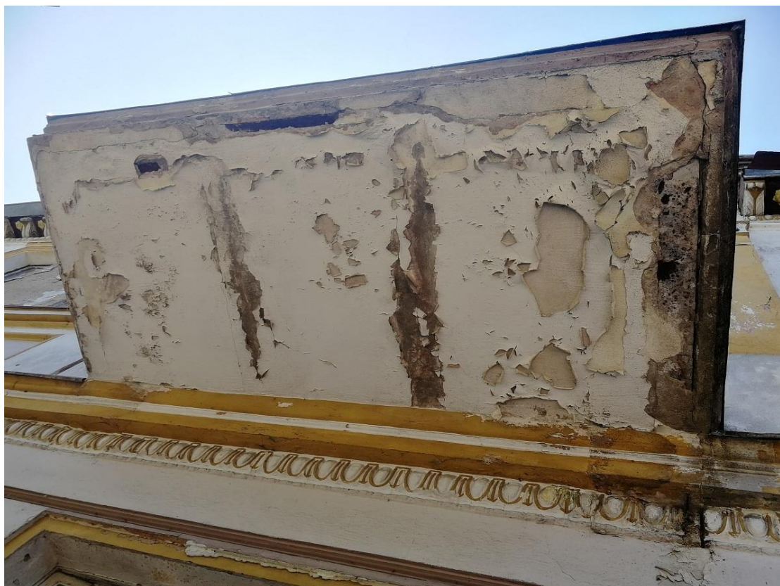
Fragmenty elewacji kamienicy – widoczne zniszczenia gzymsu wieńczącego, zalania spowodowane nieszczelnymi rynnami i rurami spustowymi oraz uszkodzenia w obrębie płyty balkonowej
