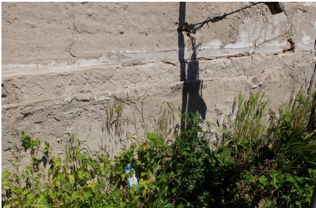
Fragment cokołu na elewacji południowej – widoczne znaczne zniszczenia tynków
