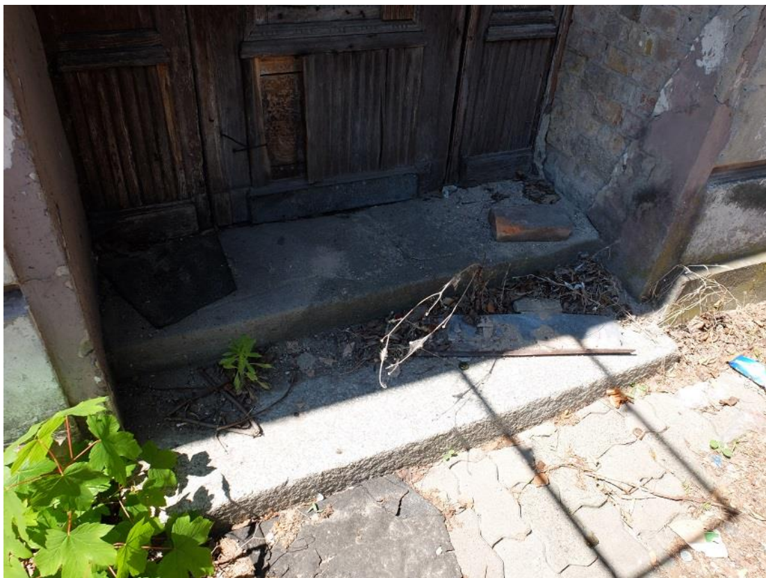
Wejście do kamienicy – stan zachowania stopni granitowych
