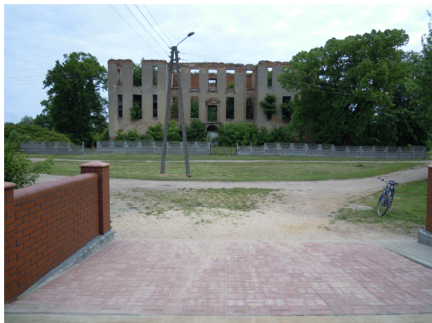
Widok na ruinę i drogę gruntową od strony zachodniej (z mostu „B”)
