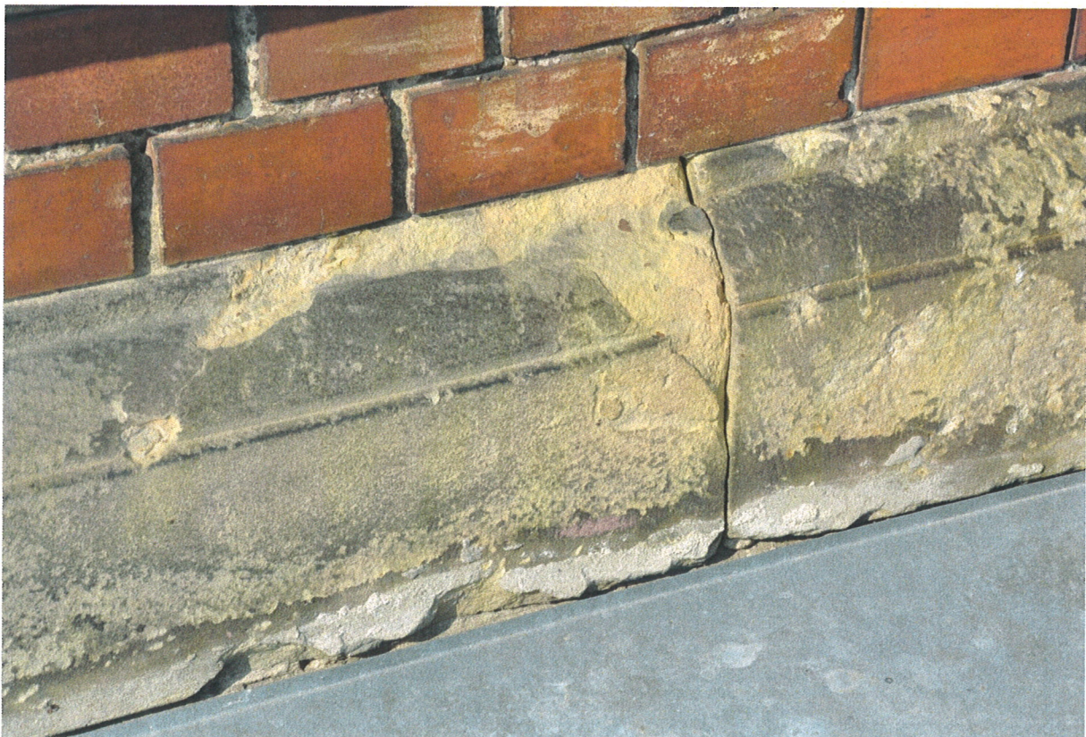
Fot. 10. Fragment kamiennego gzymsu. Widoczne strukturalne pęknięcie bloku kamienia, powierzchniowe ubytki struktury, rozszczelnienia na styku z blachą opierzenia oraz czarne, organiczne nawarstwienia pokrywające powierzchnię kamienia.
