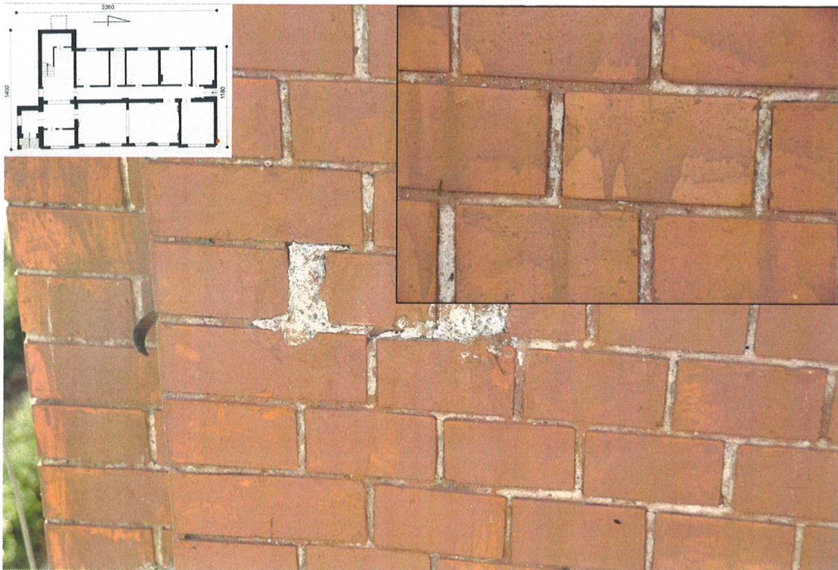
Fot. 16. Fragment elewacji północnej z widocznymi śladami wtórnych powłok malarskich pokrywających powierzchnię ceglanego lica obiektu.
