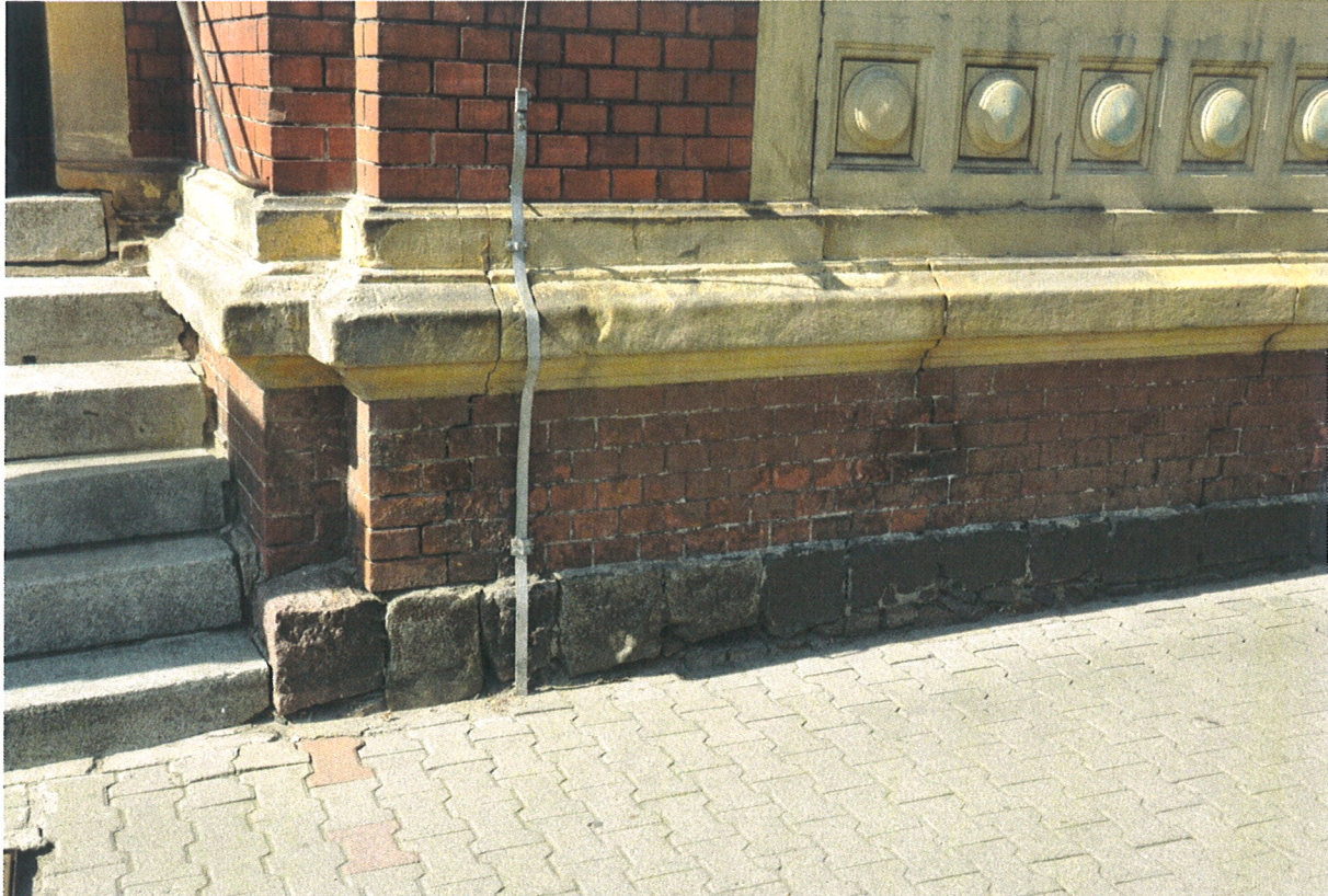
Fot. 13. Fragment strefy cokołowej elewacji frontowej obiektu. Widoczne powierzchniowe ubytki kamiennego gzymsu cokołowego, wtórne przemalowania oraz ciemne nawarstwienia pokrywające powierzchnie kamienia, ubytki zaprawy w spoinach kamiennych bloków.
