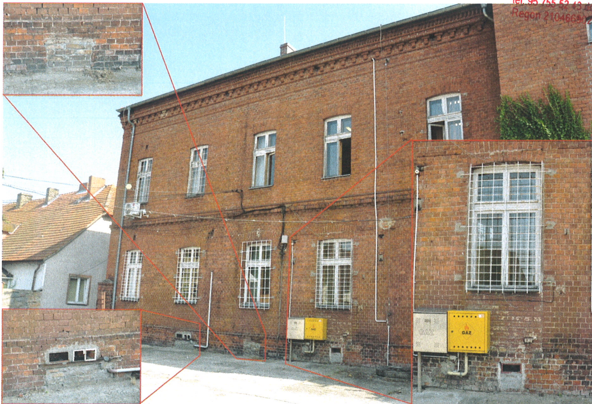
Fot.19. Fragment elewacji zachodniej budynku - obecny stan zachowania. Widoczne wtórne przekształcenia muru w obrębie strefy cokołowej – okienka piwnic oraz w obrębie otworu okiennego pierwszej kondygnacji.
