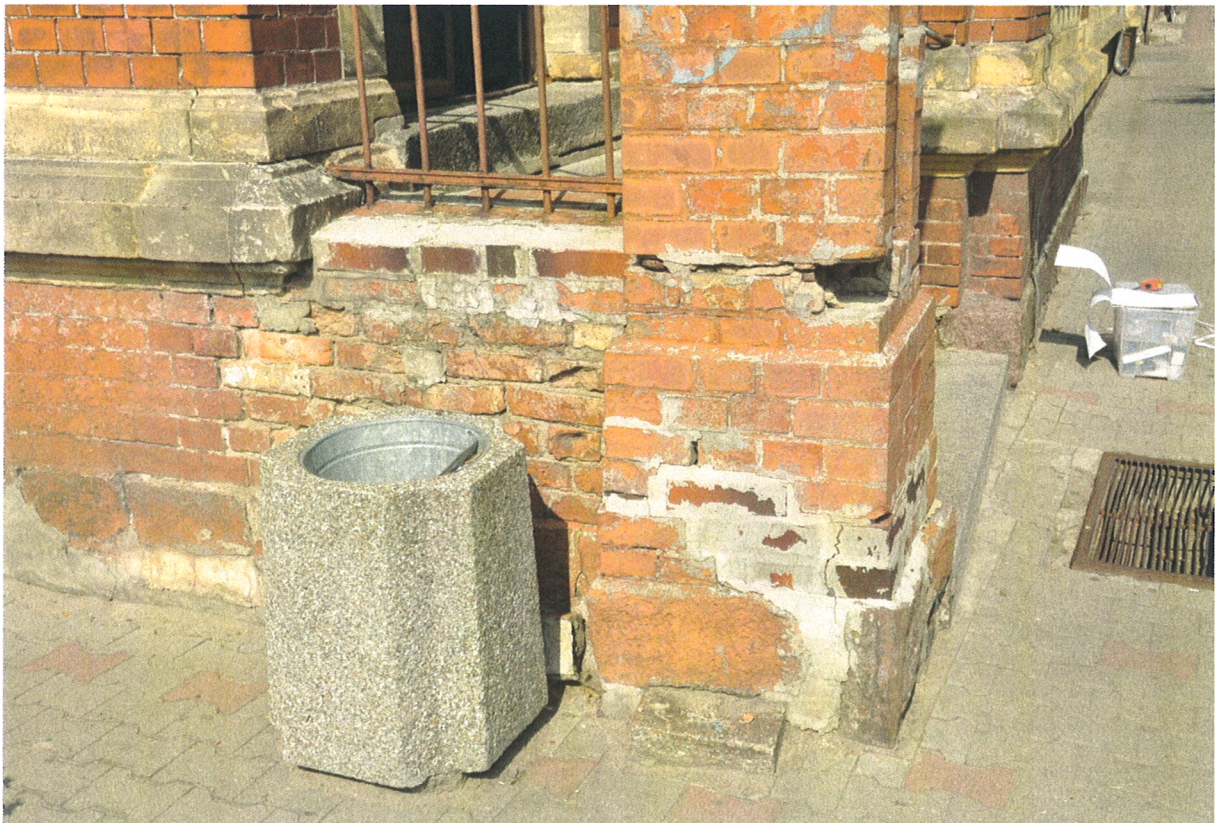
Fot. 28 Zbliżenie na fragment słupa oraz muru schodów wejścia głównego obiektu - obecny stan zachowania. Widoczne ubytki powierzchni konstrukcji słupa oraz liczne wtórne przemurowania i uzupełnienia ubytków
