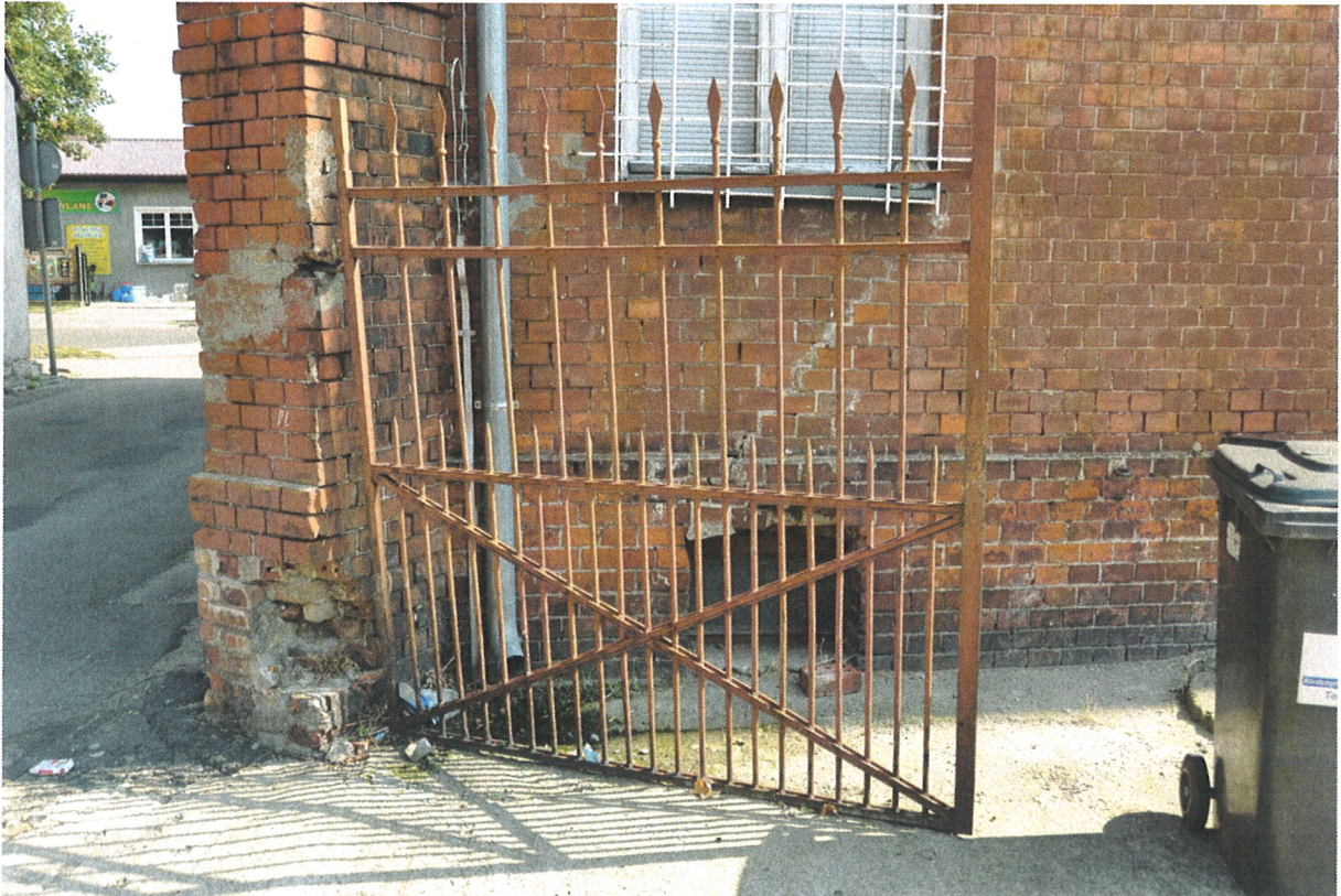
Fot. 18. Jedno z przęseł bramy wjazdowej na dziedziniec urzędu. Widoczne głębokie ubytki struktury ceglanego słupa oraz częściowe, błędnie przeprowadzone uzupełnienia powierzchni. W dolnych partiach słupa ubytek trzpienia dolnego zawiasu bramy.
