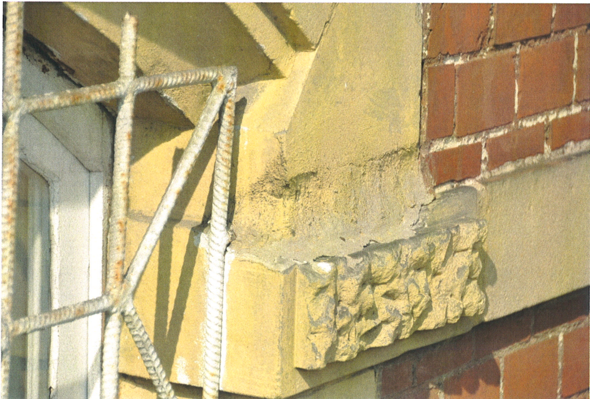
Fot. 30. Ubytki powierzchni kamiennego obramienia otworu okiennego powstałe w wyniku wtórnego montażu kraty okiennej.
