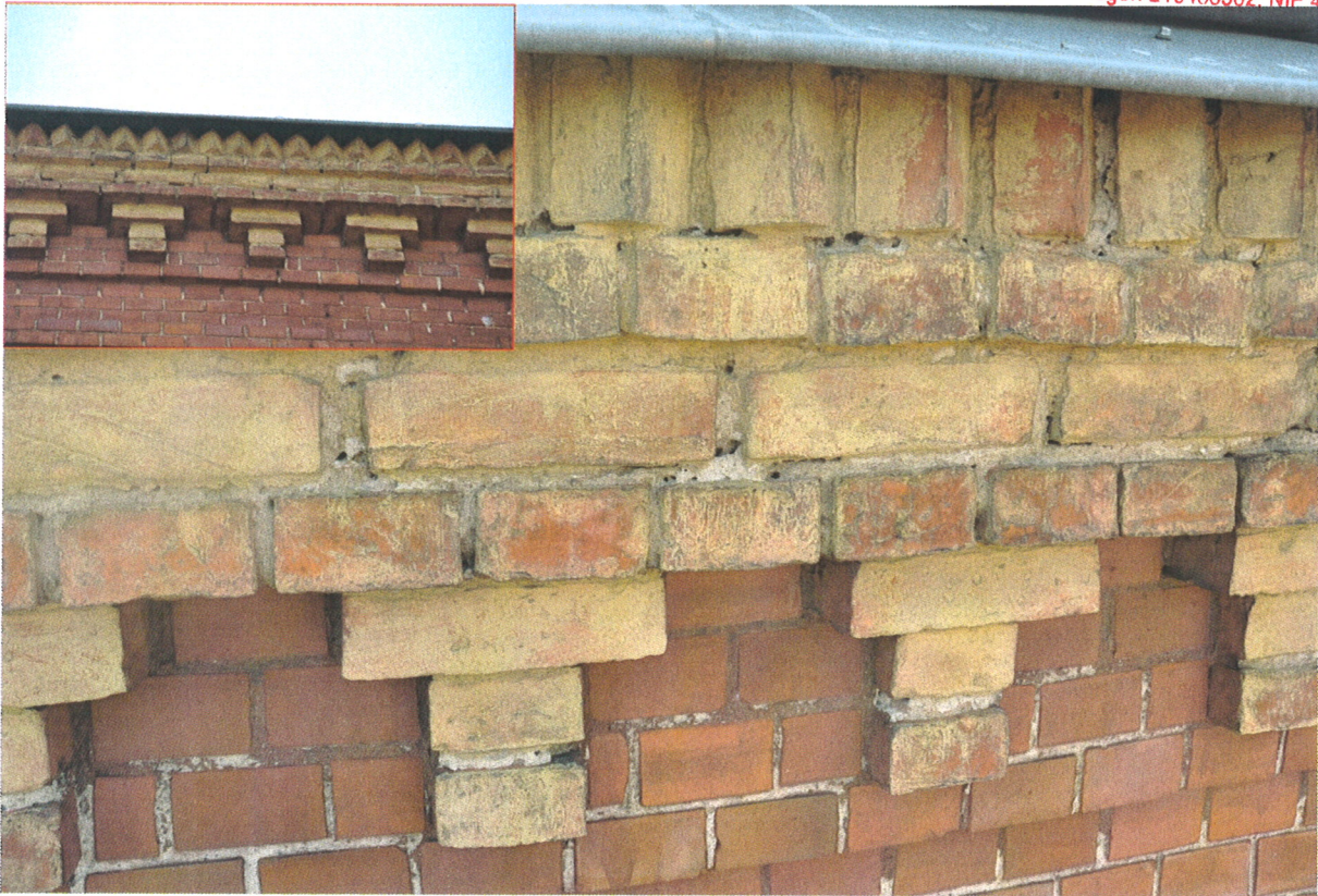
Fot. 15. Fragment gzymsu koronującego elewacji północnej - obecny stan zachowania. Widoczne m.in. ubytki zapraw w spoinach, wtórne przemalowania cegieł gzymsu powłoką malarską w kolorze ugrowym.
