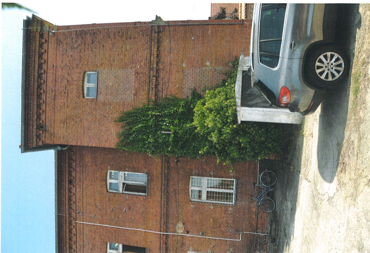
Fot. 20. Fragment elewacji zachodniej z widoczną klatką schodową- obecny stan zachowania. Widoczny m.in. zamurowany otwór okienny pierwszej kondygnacji klatki schodowej oraz przekształcenia w obrębie otworu okiennego drugiej kondygnacji.
