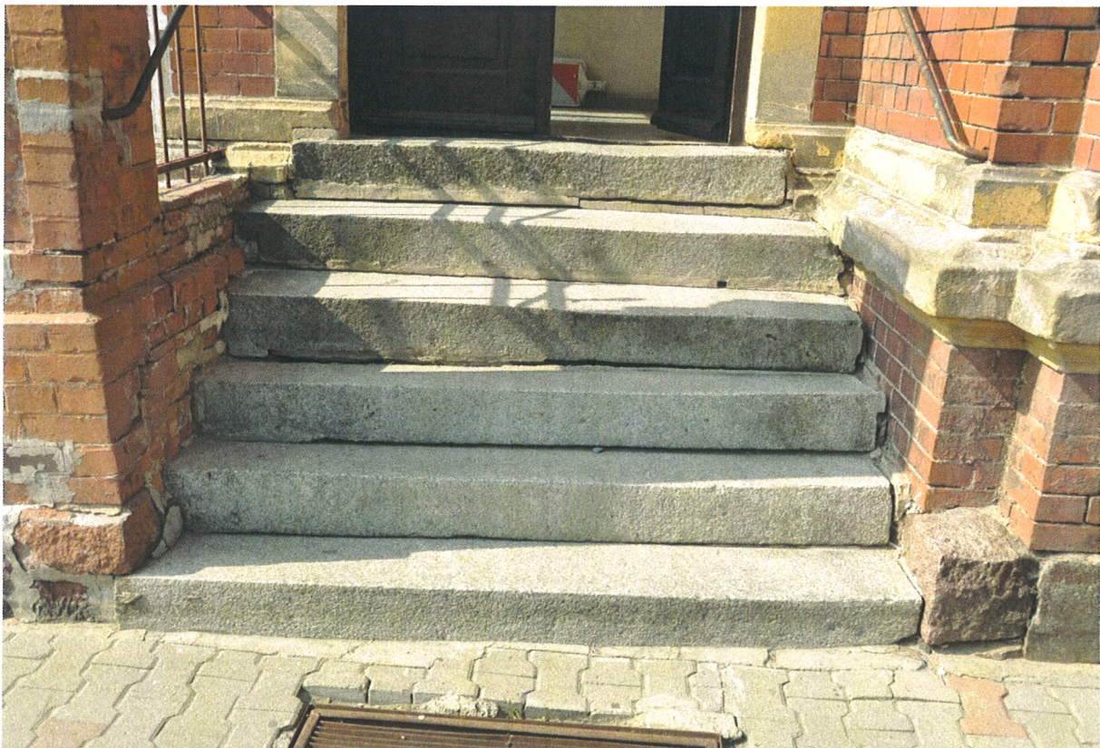
Fot. 26. Stopnie schodów głównego wejścia do obiektu. Widoczne silne rozszczelnienia oraz ubytki zaprawy w spoinach łączących poszczególne bloki granitowych stopni schodów. W przypadku części stopni stwierdzono osiadanie oraz odkształcenia od pierwotnego poziomu.
