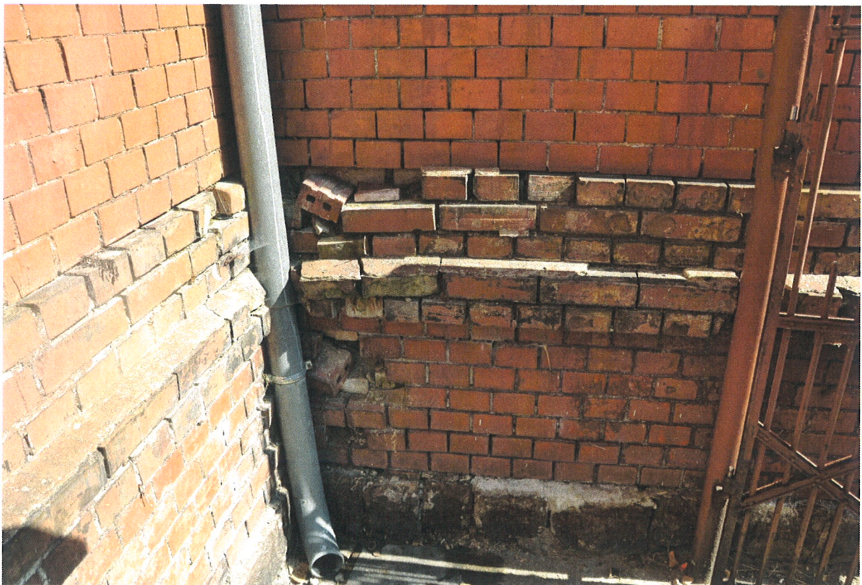
Fot. 24. Narożnik na styku elewacji południowej z elewacją zachodnią przedsionka, strefa cokołowa - obecny stan zachowania. Widoczne zniszczenia gzymsu cokołowego powstałe w wyniku nieszczelności instalacji odprowadzającej wodę deszczową z powierzchni dachu przedsionka.
