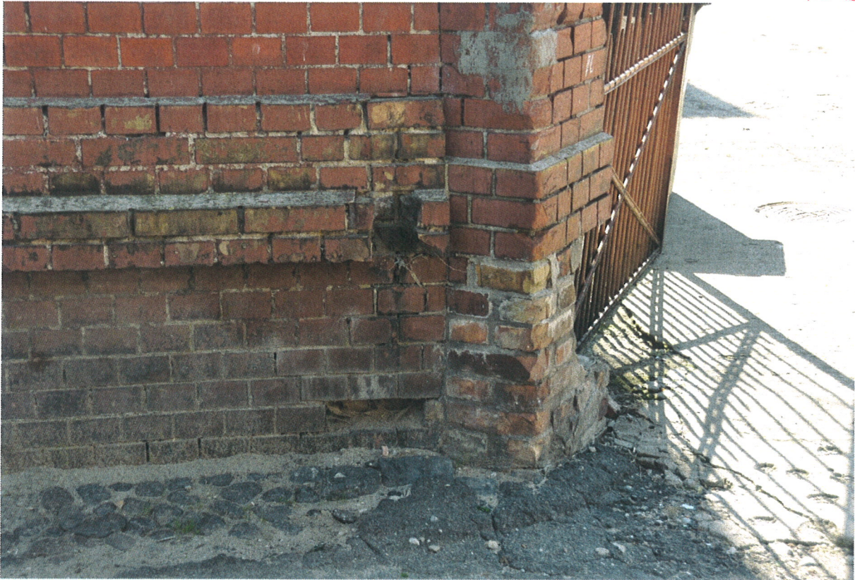
Fot. 17. Narożnik elewacji północnej. Zniszczenia w obrębie profili gzymsu strefy cokołowej oraz słupa bramy wjazdowej na dziedziniec.
