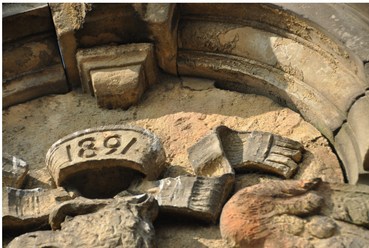
Fot. 6. Zbliżenie na dekorację prawego szczytu elewacji frontowej. Widoczna inskrypcja na wstędze i z datą powstania obiektu. Ponadto widoczne ubytki zaprawy w spoinach, powierzchniowe zniszczenia w obrębie tła dekoracji oraz powłoki malarskie pokrywające powierzchnie gzymsu.
