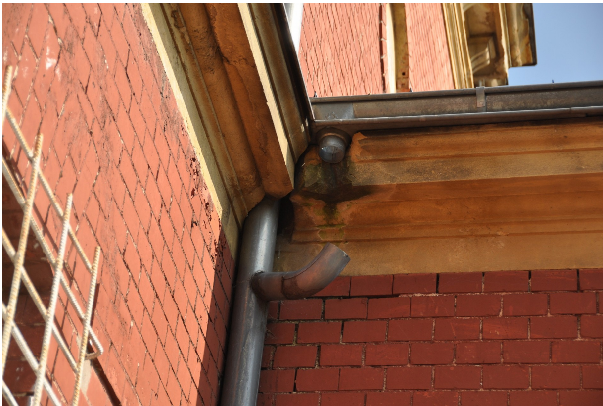
Fot. 23. Narożnik na styku elewacji południowej z elewacją zachodnią przedsionka - obecny stan zachowania. Widoczne przerwane połączenie rury spustowej z rynną dachu przedsionka. W wyniku silnego zawilgocenia powierzchnie gzymsu koronującego ze śladami przebarwień oraz pokryte licznymi koloniami mikroorganizmów.
