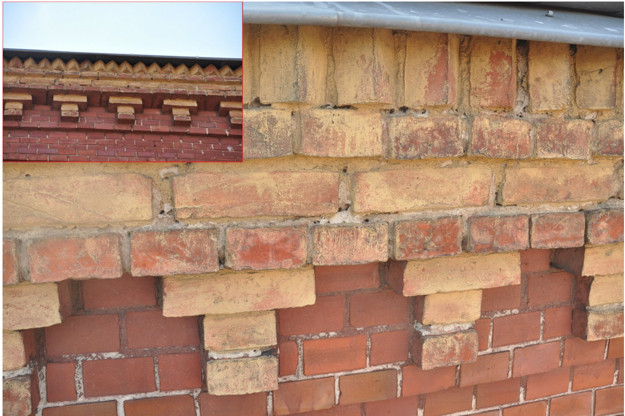
Fot. 15. Fragment gzymsu koronującego elewacji północnej - obecny stan zachowania. Widoczne m.in. ubytki zapraw w spoinach, wtórne przemalowania cegieł gzymsu powłoką malarską w kolorze ugrowym.
