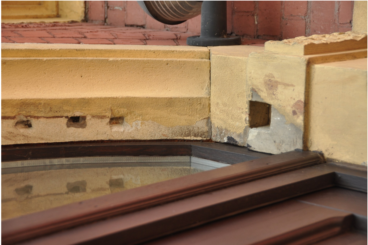
Fot. 29. Obramienie głównego wejścia do obiektu. Widoczne m.in. gniazda pierwotnej konstrukcji stolarki drzwiowej obiektu.
