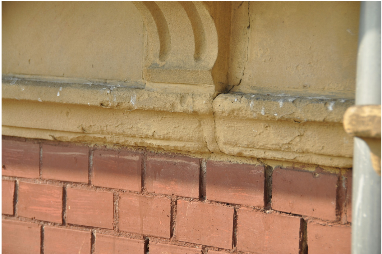
Fot. 8. Fragment kamiennego gzymsu koronującego oraz ceglanego lica elewacji frontowej. W obrębie gzymsu widoczne ubytki powierzchni, ślady dezintegracji granularnej, rozwarstwienia oraz spęcherzenia. Ponadto, powierzchnia kamienia oraz zaprawy w spoinach wtórnie pokryte żółtą powłoką kamienia.
