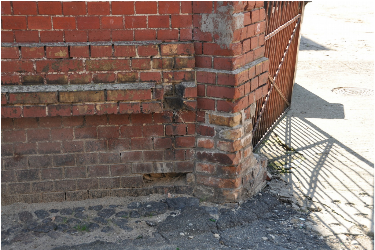
Fot. 17. Naróżnik elewacji północnej. Zniszczenia w obrębie profili gzymsu strefy cokołowej oraz słupa bramy wjazdowej na dziedziniec.
