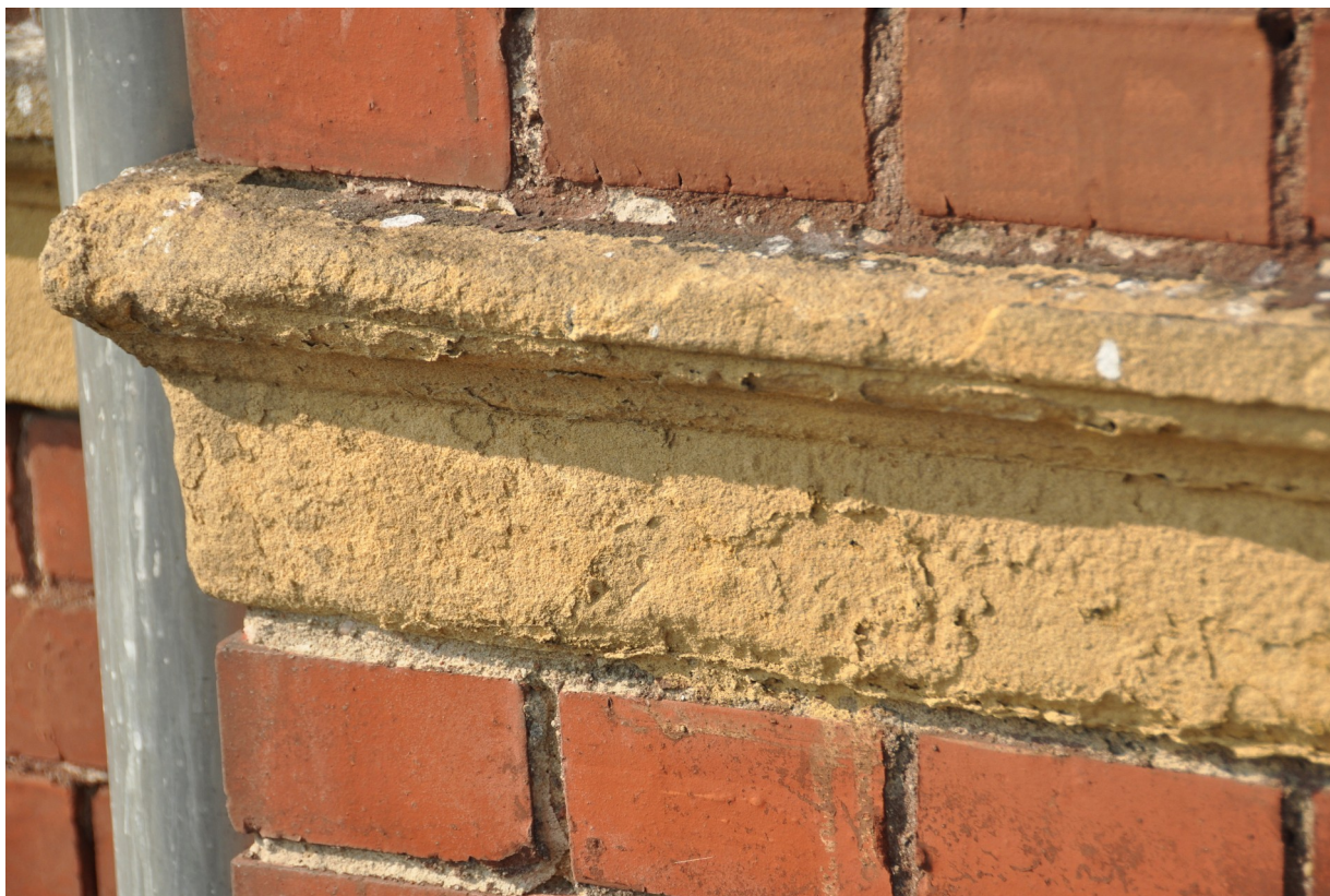
Fot. 12. Fragment gzymsu międzykondygnacyjnego - obecny stan zachowania. Widoczne wtórne przemalowanie powierzchni kamienia, uszczelnienie przypowierzchniowych warstw, jego rozwarstwienia oraz powierzchniowe ubytki struktury.
