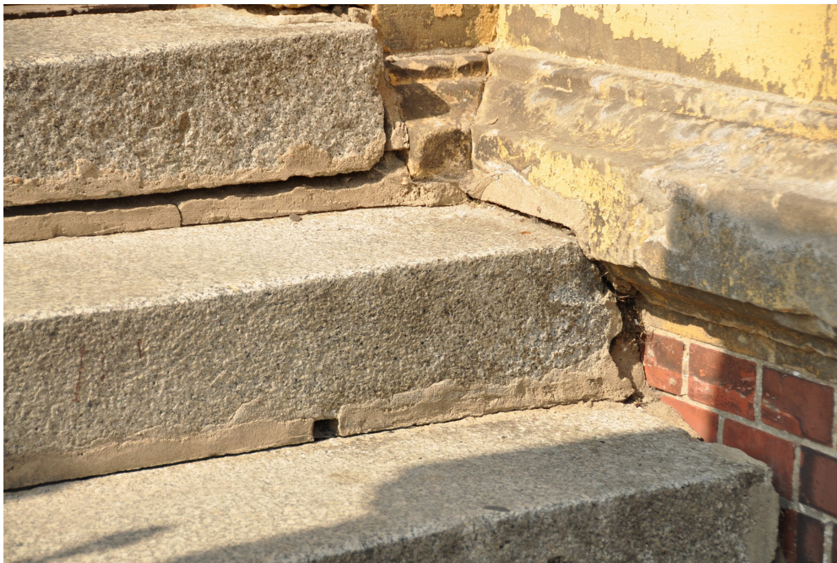
Fot. 27. Zbliżenie na część stopni schodów na styku z elewacją budynku. Widoczne silne rozszczelnienia stopni oraz deformacje ich układu. Ponadto, widoczny fragment gzymsu cokołowego pokrytego wtórną (ugrową) powłoką malarską oraz czarnymi nawarstwieniami.
