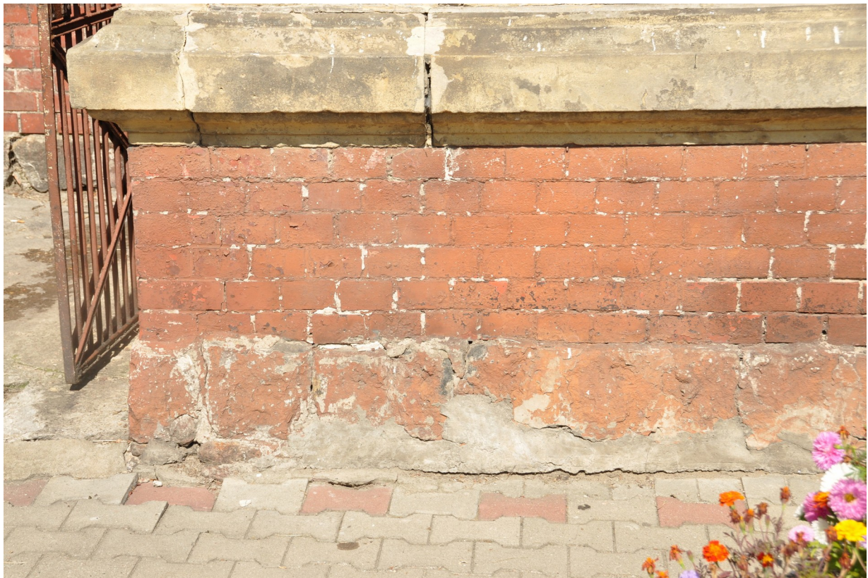
Fot. 25. Strefa cokołowa w obrębie elewacji południowej przedsionka. Widoczne czarne nawarstwienia pokrywające powierzchnie kamiennego gzymsu; ubytki zaprawy w spoinach; wtórne powłoki malarskie oraz błędnie przeprowadzone uzupełnienia ubytków zaprawy w spoinach muru.
