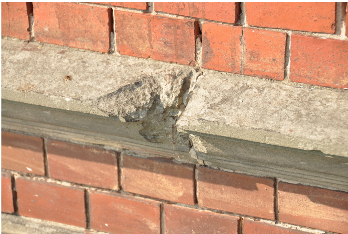
Fot. 11. Fragment gzymsu międzykondygnacyjnego, obecny stan zachowania. Widoczny m.in. mechaniczny ubytek powierzchni kamienia.
