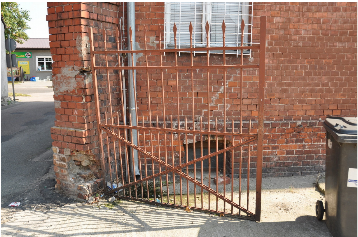
Fot. 18. Jedno z przesł bramy wjazdowej na dziedziniec urzędu. Widoczne głębokie ubytki struktury ceglanego słupa oraz częściowe, błędnie przeprowadzone uzupełnienia powierzchni. W dolnych partiach słupa ubytek trzpienia dolnego zawiasu bramy.
