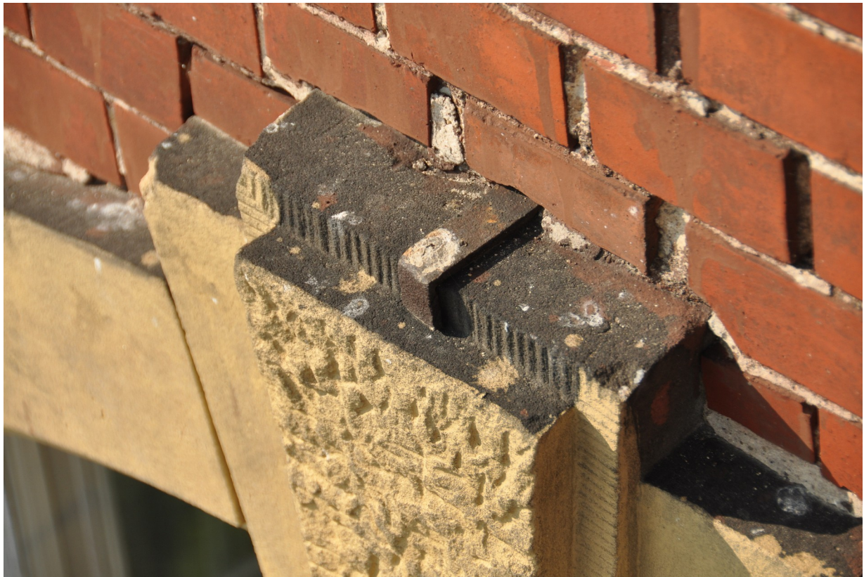
Fot. 9. Fragment kamiennego zwornika i obramienia otworu okiennego. Widoczne czarne nawarstwienia pokrywające górne powierzchnie kamienia, które nie zostały wtórnie przemalowane żółtą powłoką malarską celem wygubienia nawarstwień.
