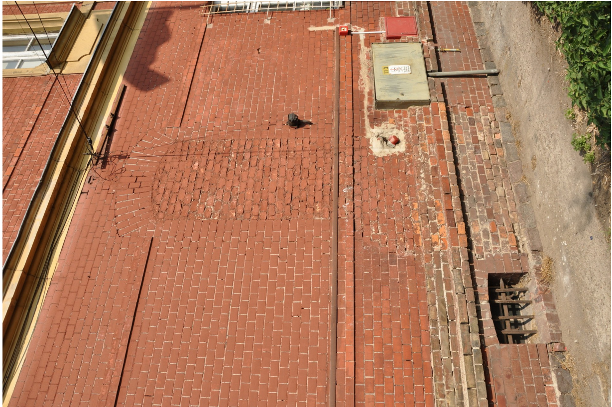
Fot. 21. Fragment elewacji południowej budynku - obecny stan zachowania. Widoczne m. in. przemalowania ceglanego lica muru, wtórne zamurowanie otworu okiennego, przekształcenia w obrębie strefy cokołowej (w tym obecność elementów instalacji elektrycznej).
