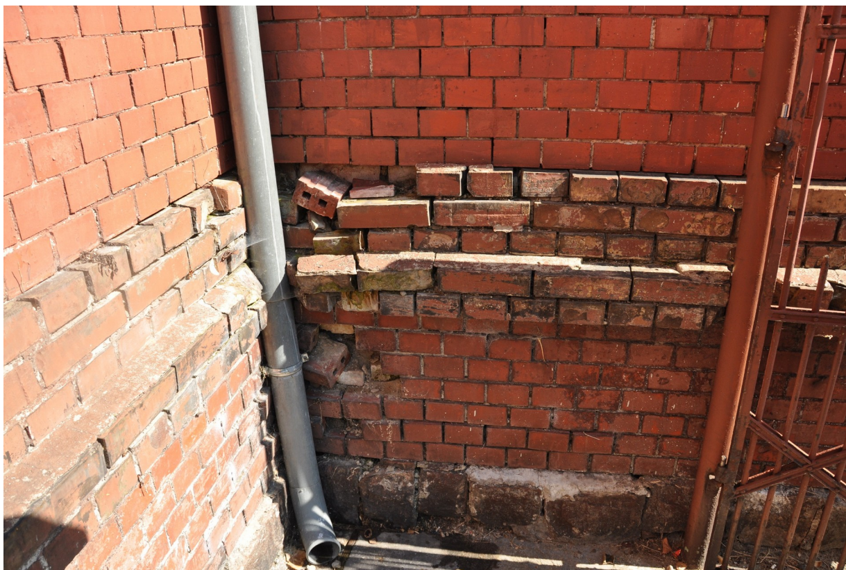
Fot. 24. Narożnik na styku elewacji południowej z elewacją zachodnią przedsionka, strefa cokołowa - obecny stan zachowania. Widoczne zniszczenia gzymsu cokołowego powstałe w wyniku nieuszczelnienia instalacji odprowadzającej wodę deszczową z powierzchni dachu przedsionka.
