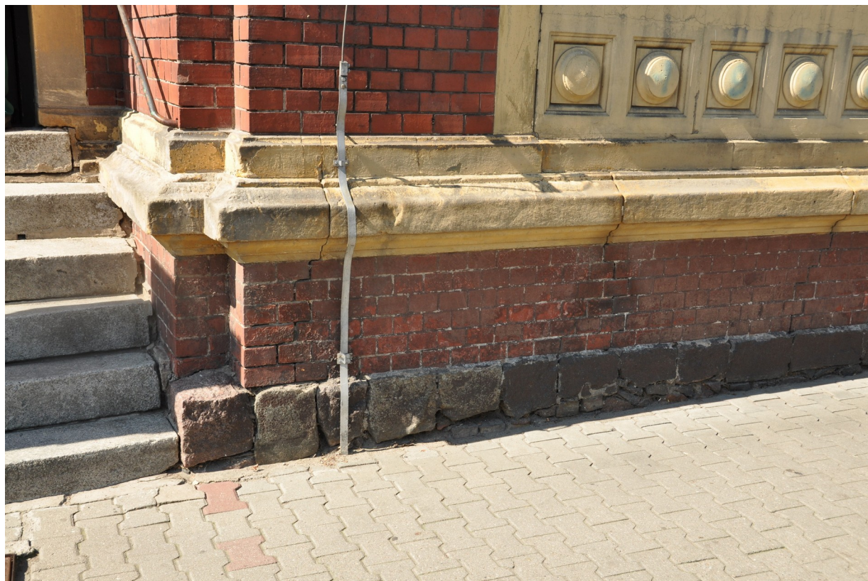
Fot. 13. Fragment strefy cokołowej elewacji frontowej obiektu. Widoczne powierzchniowe ubytki kamiennego gzymsu cokołowego, wtórne przemalowania oraz ciemne nawarstwienia pokrywające powierzchni kamienia, ubytki zaprawy w spoinach kamiennych bloków.
