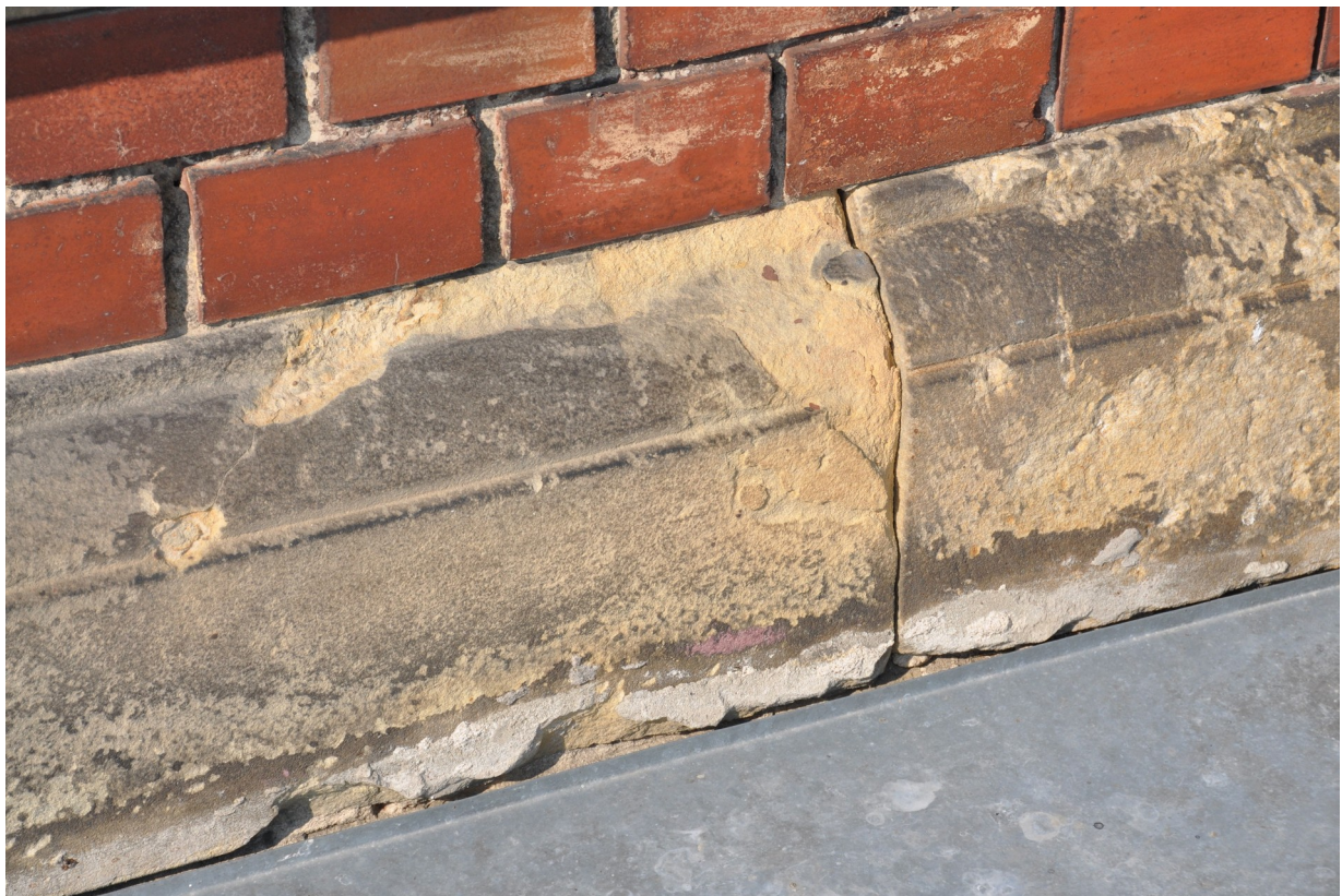
Fot. 10. Fragment kamiennego gzymsu. Widoczne strukturalne pęknięcie bloku kamienia, powierzchniowe ubytki struktury, rozszczelnienia na styku z blachą opierzenia oraz czarne, organiczne nawarstwienia pokrywające powierzchnię kamienia.
