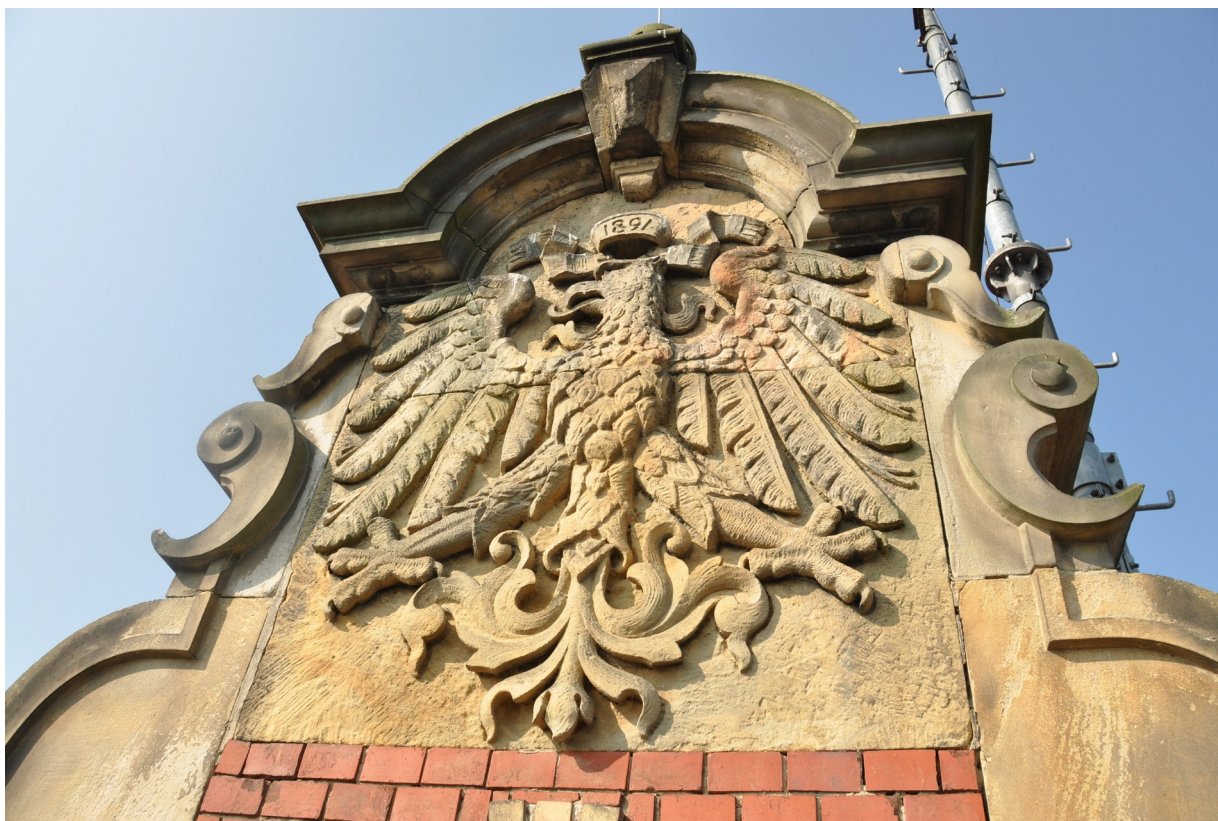
Fot. 5. Obecny stan zachowania płaskorzeźby orła w obrębie prawego szczytu elewacji frontowej. Na powierzchni korony inskrypcja z datą powstania obiektu – 1891.
