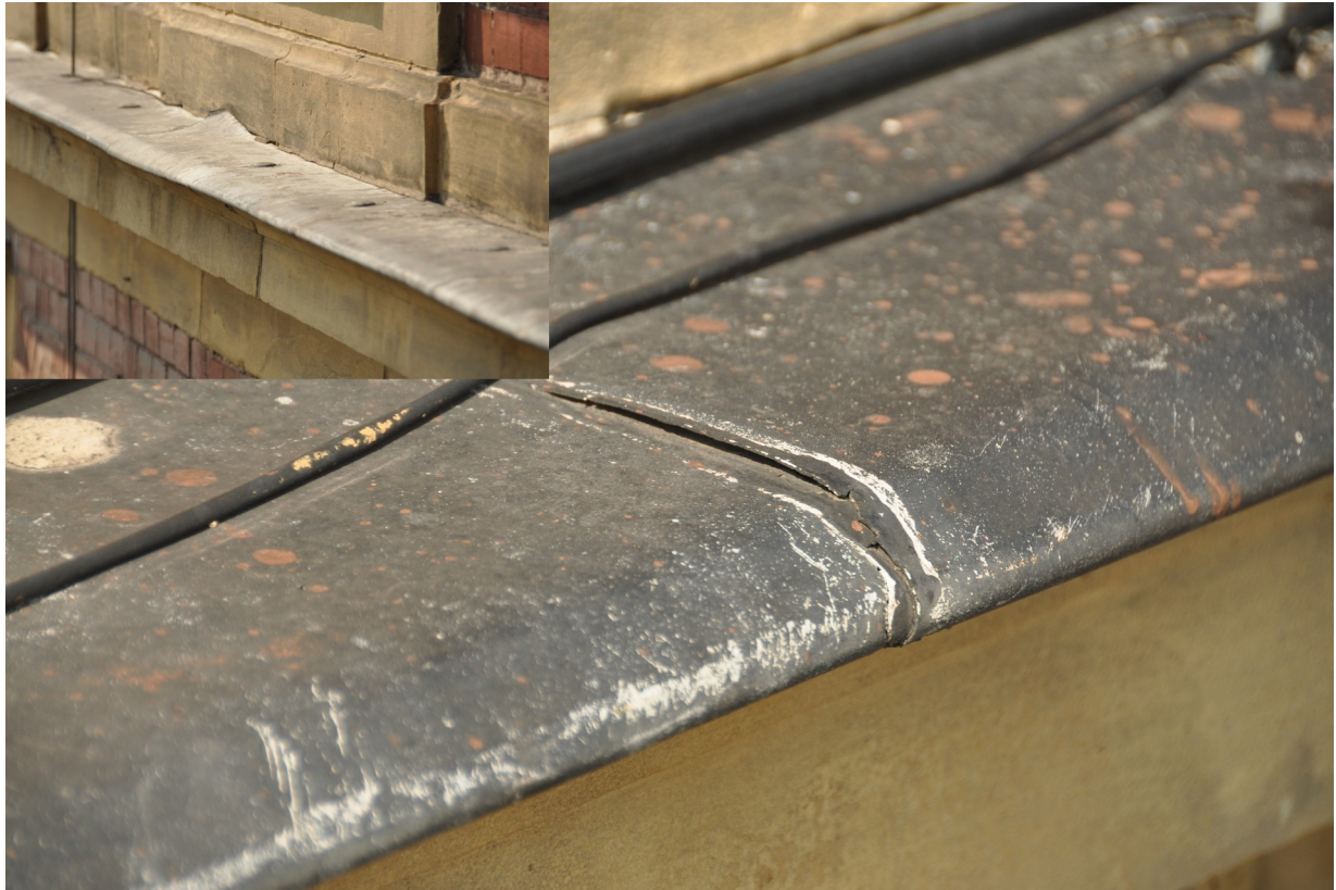
Fot. 7. Fragmenty opierzenia gzymsów - widoczne m.in. rozszczerzenia oraz deformacje blachy.
