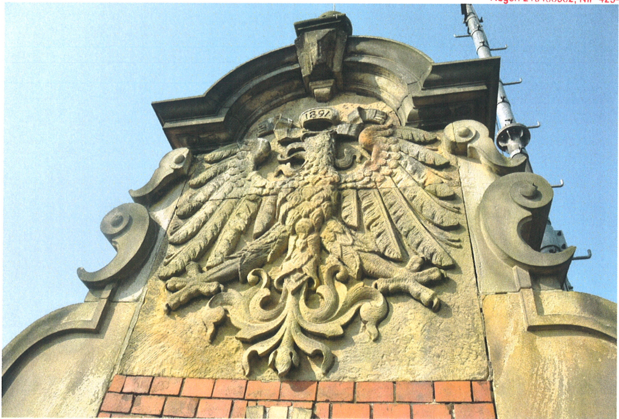
Fot. 5. Obecny stan zachowania płaskorzeźby orła w obrębie prawego szczytu elewacji frontowej. Na powierzchni korony inskrypcja z datą powstania obiektu – 1891.
