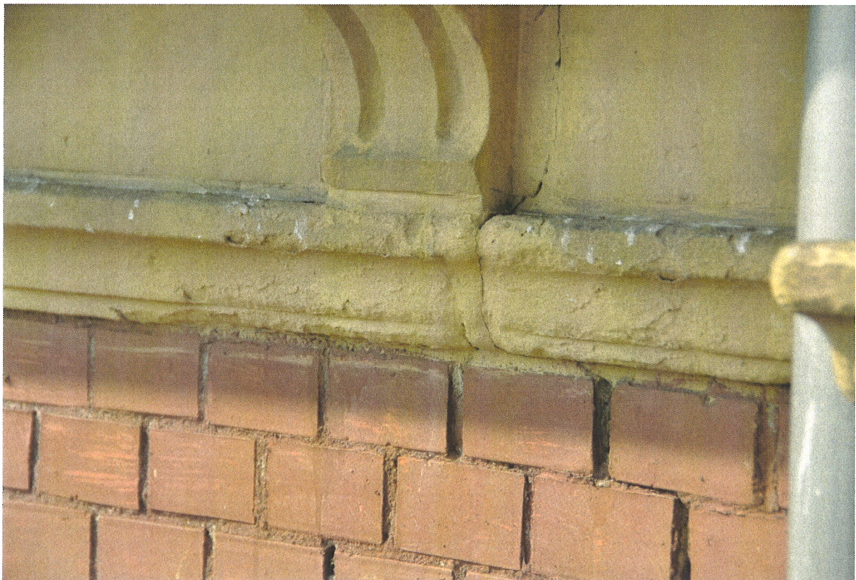
Fot. 8. Fragment kamiennego gzymsu koronującego oraz ceglanego lica elewacji frontowej. W obrębie gzymsu widoczne ubytki powierzchni, ślady dezintegracji granularnej, rozwarstwienia oraz spęcherzenia. Ponadto, powierzchnia kamienia oraz zaprawy w spoinach wtórnie pokryte żółtą powłoką kamienia.
