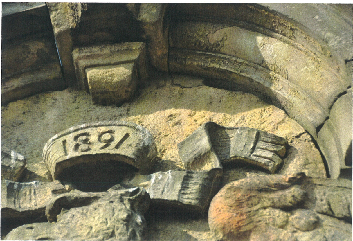
Fot. 6. Zbliżenie na dekorację prawego szczytu elewacji frontowej. Widoczna inskrypcja na wstędze i z datą powstania obiektu. Ponadto widoczne ubytki zaprawy w spoinach, powierzchniowe zniszczenia w obrębie tła dekoracji oraz powłoki malarskie pokrywające powierzchnie gzymsu.
