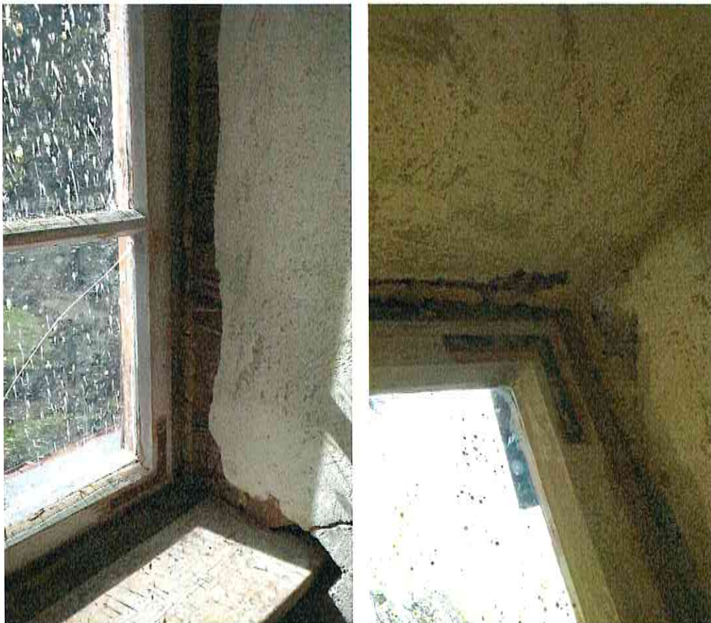
Stan techniczny obudowy lukarny oraz okna po stronie południowej budynku
