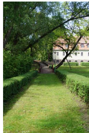
Zdj. Nr 12 Widok mostku w oddali, zauważalne przechylenie konstrukcji mostku – stan istniejący
