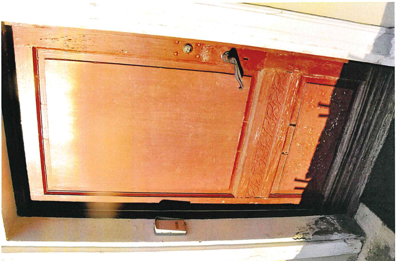
Fot. 14. Stolarka drzwiowa łącznika w obrębie elewacji południowej, aktualny stan zachowania.
