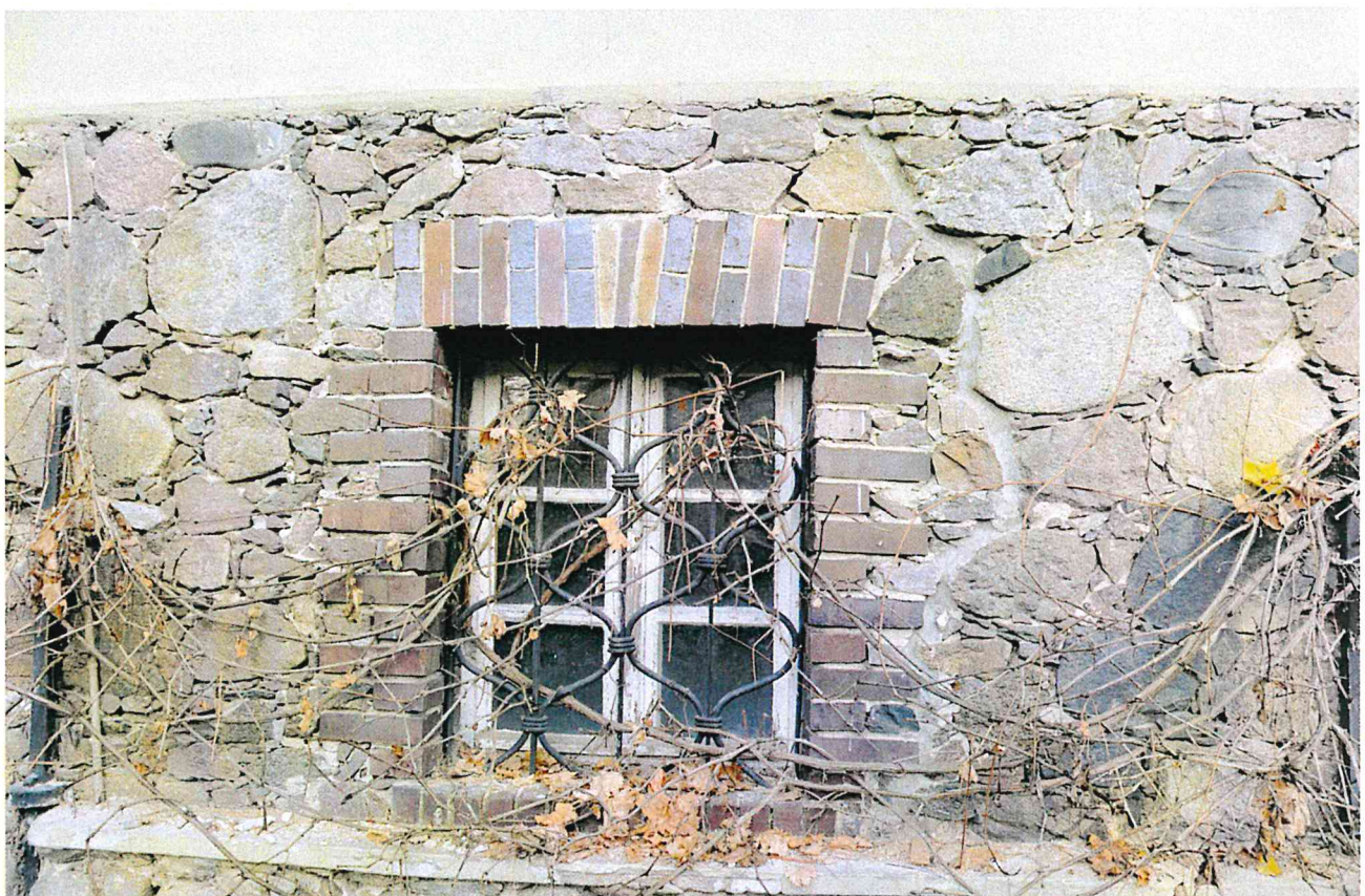
Fot. 10. Stefa cokołowa elewacji południowej, widoczne m.in. zabezpieczenie pęknięcia struktury muru, rozwój roślinności wyższej.
