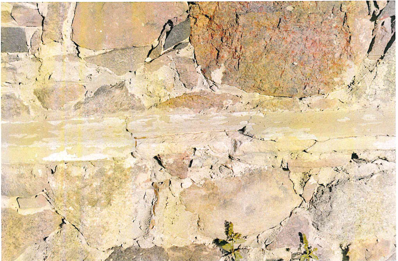
Fot. 9. Gzyms w obrębie strefy cokołowej, widoczne m.in. ubytki warstwy malarskiej oraz spękania i rozwarstwienia struktury wyprawy tynkarskiej.
