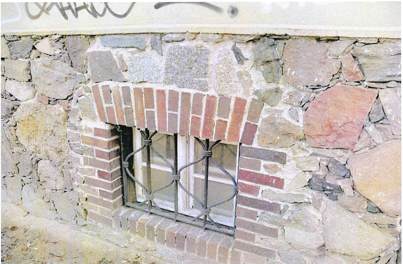
Fot. 12. Elewacja zachodnia, widoczne błędnie wykonane uzupełnienia ubytków kamiennego lica z użyciem jasno zabarwionych granitowych głazów.
