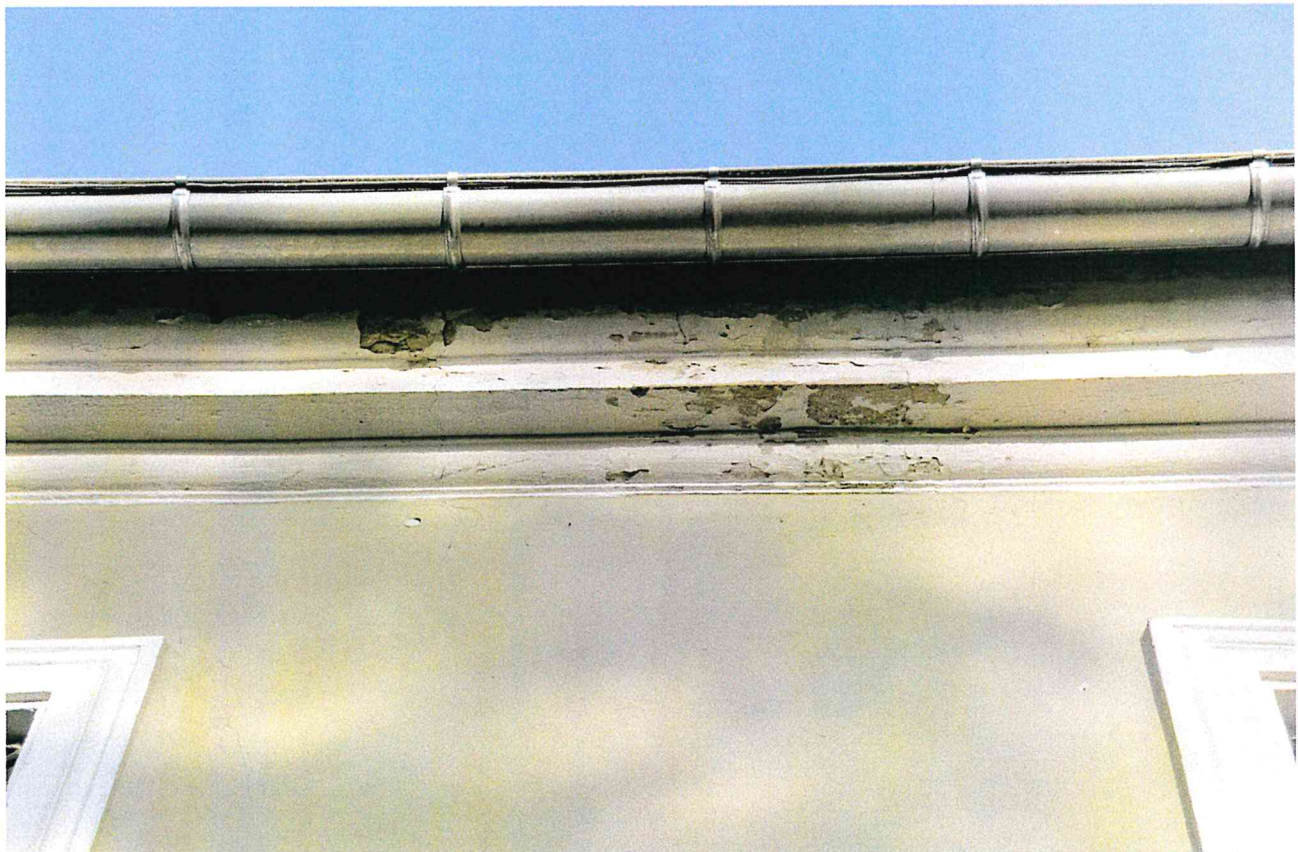
Fot. 6. Elewacja południowa, zbliżenie na gzyms koronujący. Widoczne zniszczenia powstałe w wyniku nieszczelności rynien.
