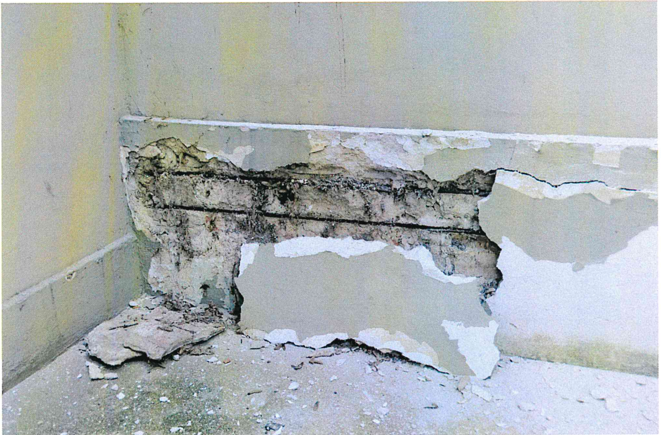
Fot. 15. Strefa cokołowa łącznika w obrębie elewacji północnej, aktualny stan zachowania. Widoczne odspojenia wyprawy tynkarskiej oraz silna korozja stalowego dwuteownika.
