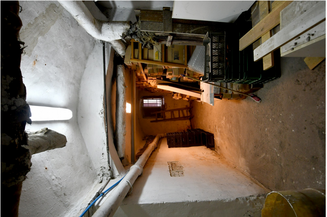
I/15. Oficyna dworu starostów międzyrzeckich część A2 – piwnica, pom. 01/9a,b, widoczne odcinkowe sklepienie z fazy IA, widok od północnego – zachodu
