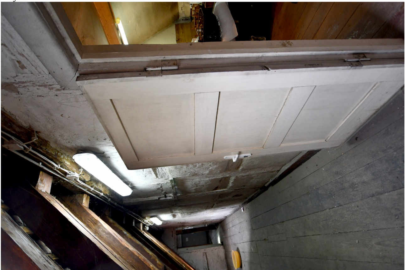
I/6. Oficyna dworu starostów międzyrzeckich część B – poddasze, pom. 1/2, widok od wschodu, widoczne szachulcowe oddzielenie pom. 1/4 i 1/5 oraz jednoskrzydłowe drzwi płycinowe z fazy IV
