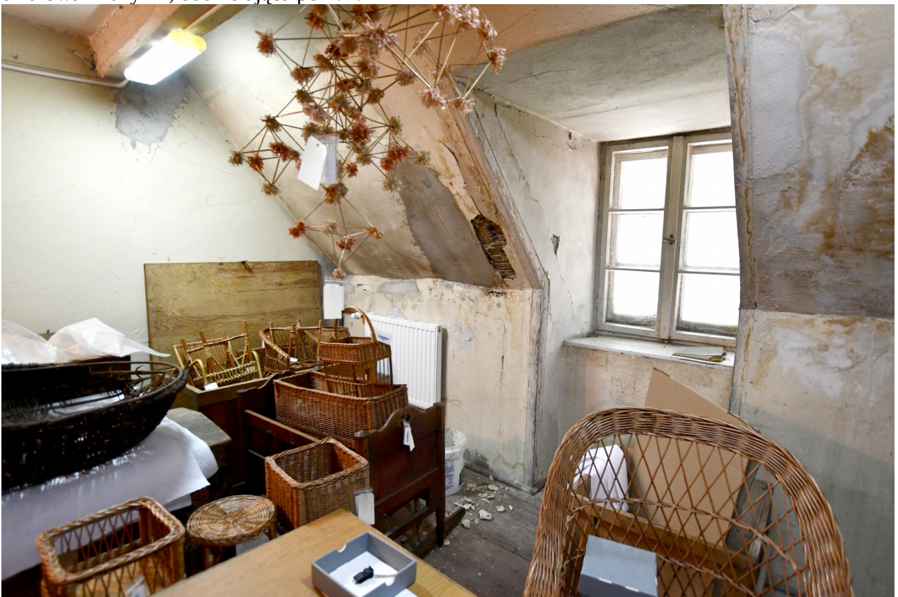
I/8. Oficyna dworu starostów międzyrzeckich część B – poddasze, wnętrze pom. 1/4, widok od wschodu, widoczne ocieplenie połaci dachowej glinobitką i stolarka okienna lukarny z fazy III
