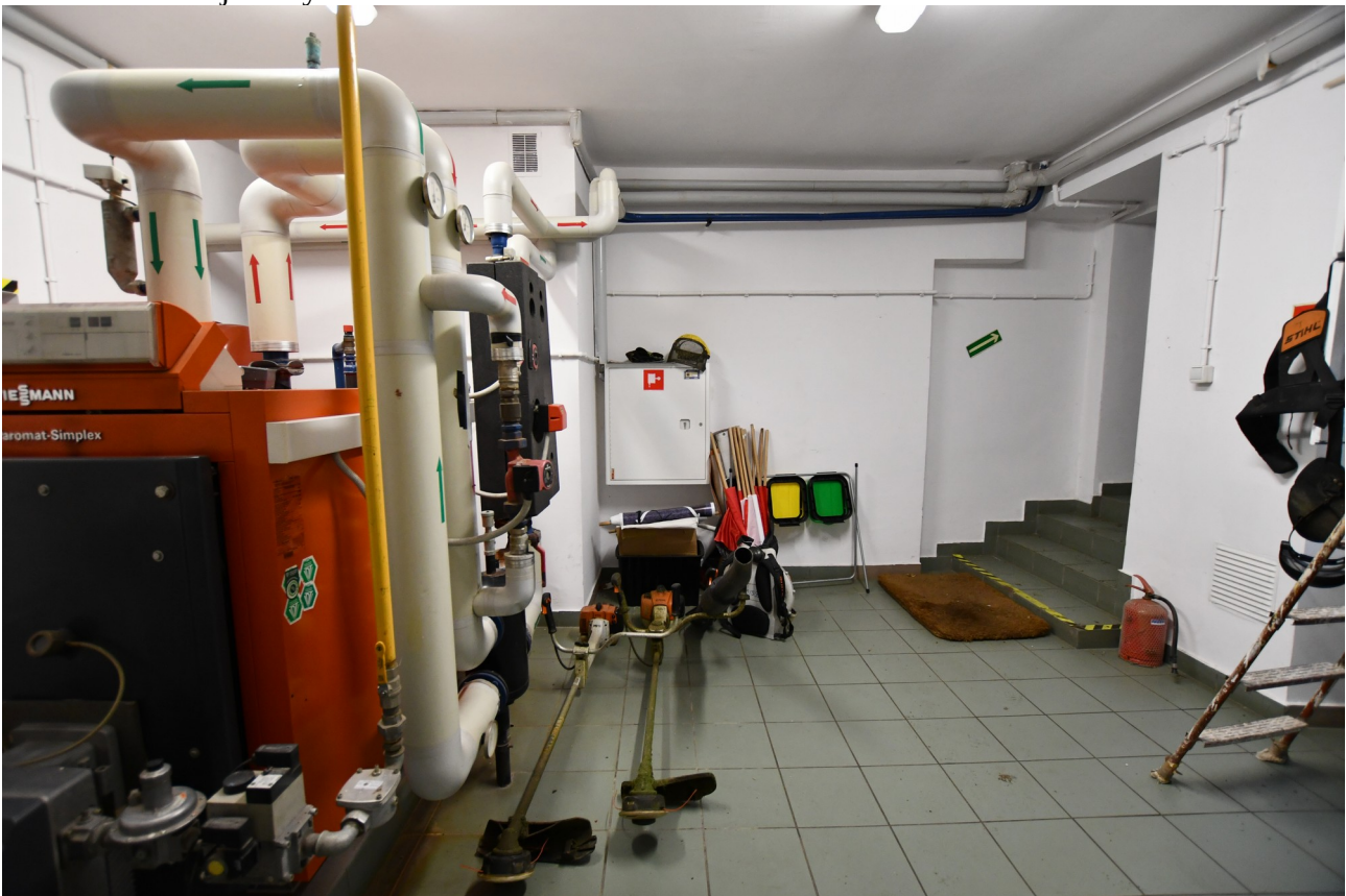
I/14. Oficyna dworu starostów międzyrzeckich część A1 – piwnica, pom. 01/4, wnętrze kotłowni, widok ogólny od południowego – zachodu
