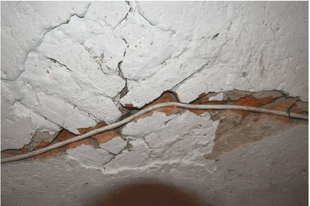
III/22. Oficyna dworu starostów międzyrzeckich, część A2, piwnice, pom. 01/9b, odkrywka sklepienia kolebkowego z cegieł ułożonych w jodełkę z fazy II
