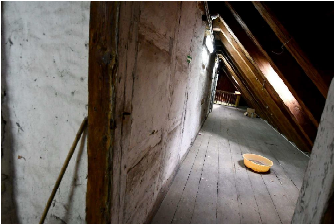
III/3. Oficyna dworu starostów międzyrzeckich, część B, poddasze, pom. 1/2, ścianka szachulcowa z fazy II (ok. 1829 r.)
