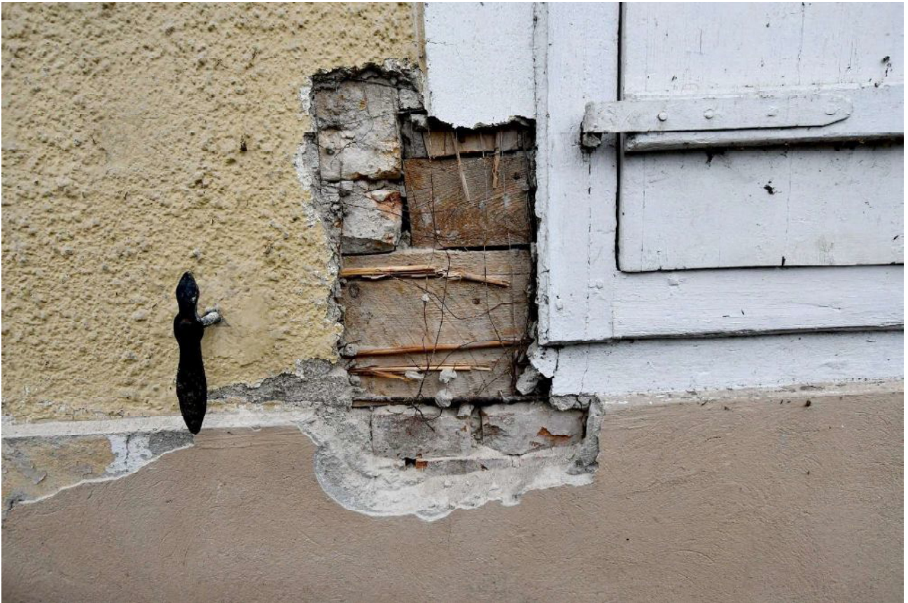
III/8. Oficyna dworu starostów międzyrzeckich, część B, elewacja północno – zachodnia, odkrywka częściowo uzupełnianej konstrukcji szachulcowej przy dolnym północnym narożniku okna pom. 0/9, widoczne wtórne wypełnienie ściany cegła pełną, poniżej odkrywki ściana w pełni
