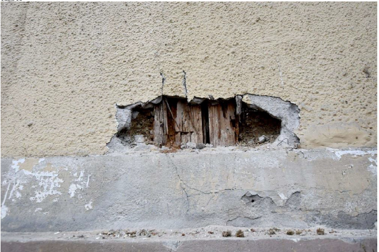
III/7. Oficyna dworu starostów międzyrzeckich, część B, elewacja południowo – wschodnia, odsłonięta, zerodowana, dolna partia słupa konstrukcji szachulcowej na styku z opaską skarpy cokołu, po obu stronach słupa stwierdzono pierwotne gliniane wypełnienie ściany, faza Ib
