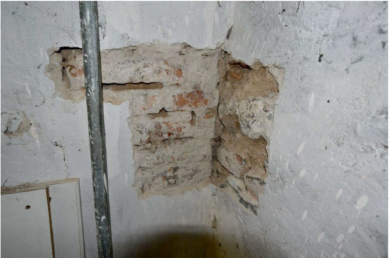
III/20. Oficyna dworu starostów międzyrzeckich, część A2, piwnice, pom. 01/9a, odkrywka w narożniku ścian: południowo – zachodniej i północno – zachodniej (ściany dworu)
