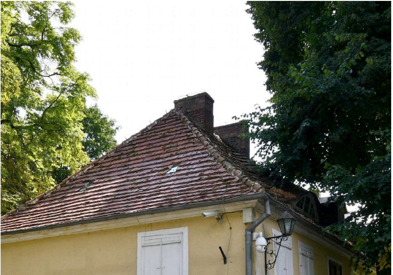
III/6. Oficyna dworu starostów międzyrzeckich, część B, elewacja północno – zachodnia, drewniany gzyms wieńczący, faza Ib
