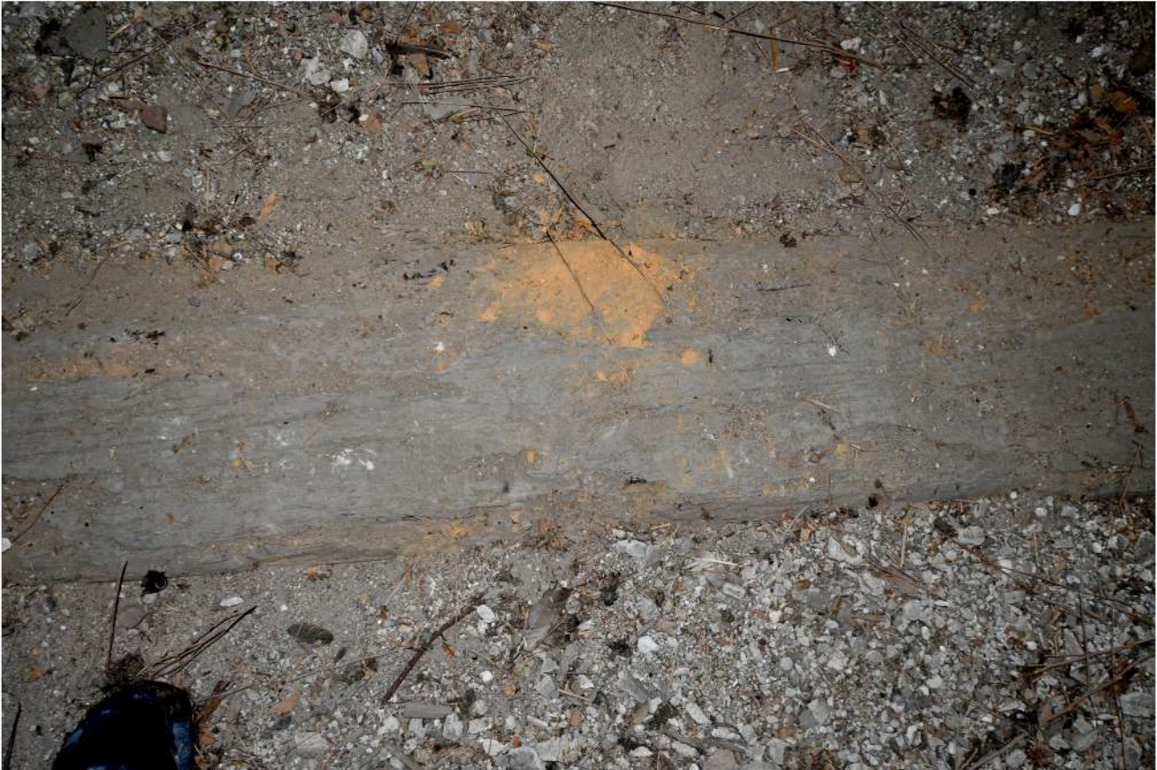
II/15. Oficyna dworu starostów międzyrzeckich, część B, poddasze, pom. 1/3, widoczny ślad uszkodzenia belki stropowej przez spuszczała
