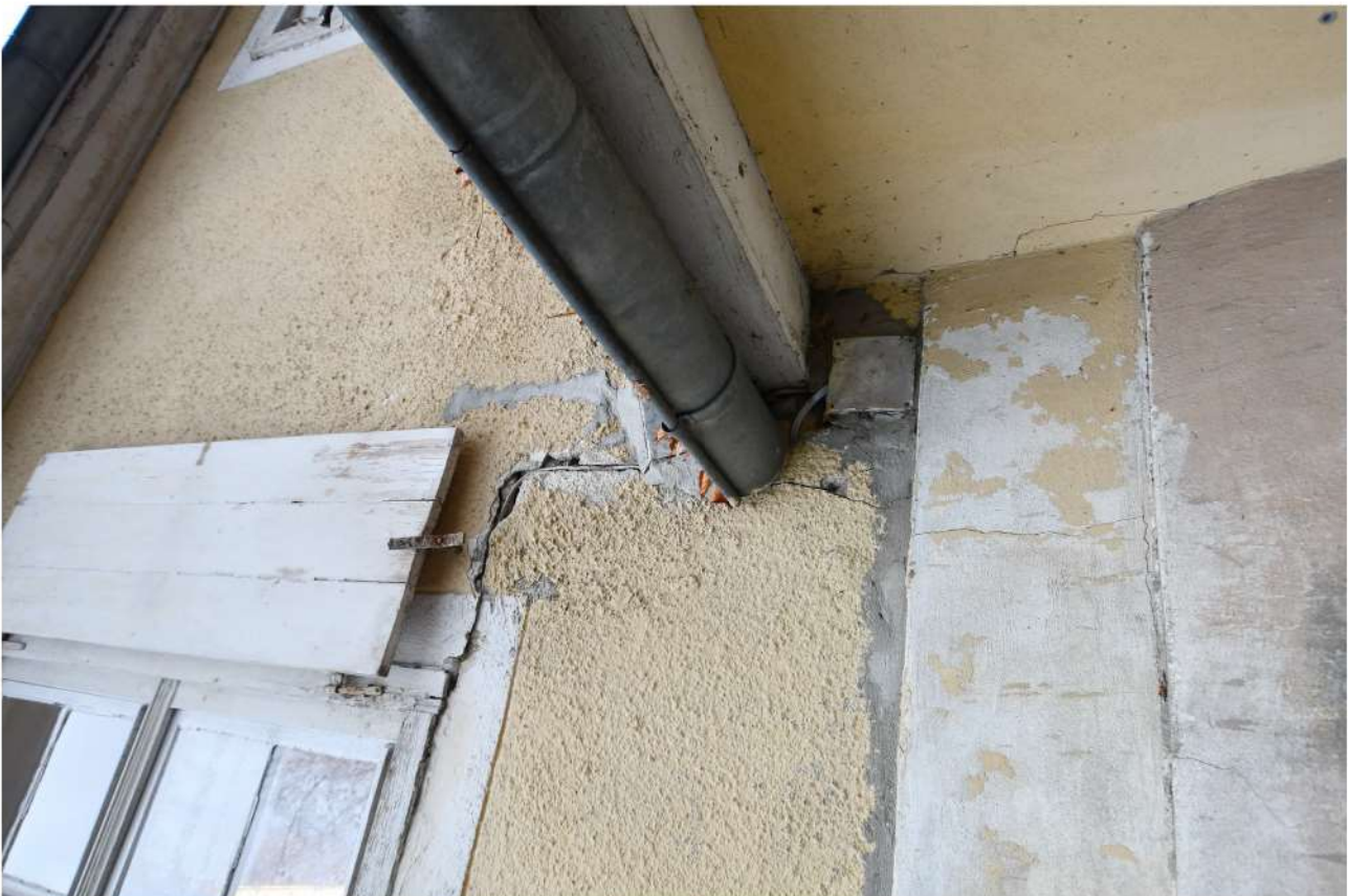
II/6. Oficyna dworu starostów międzyrzeckich, elewacja południowo wschodnia, widoczne pionowe pęknięcie tynku
