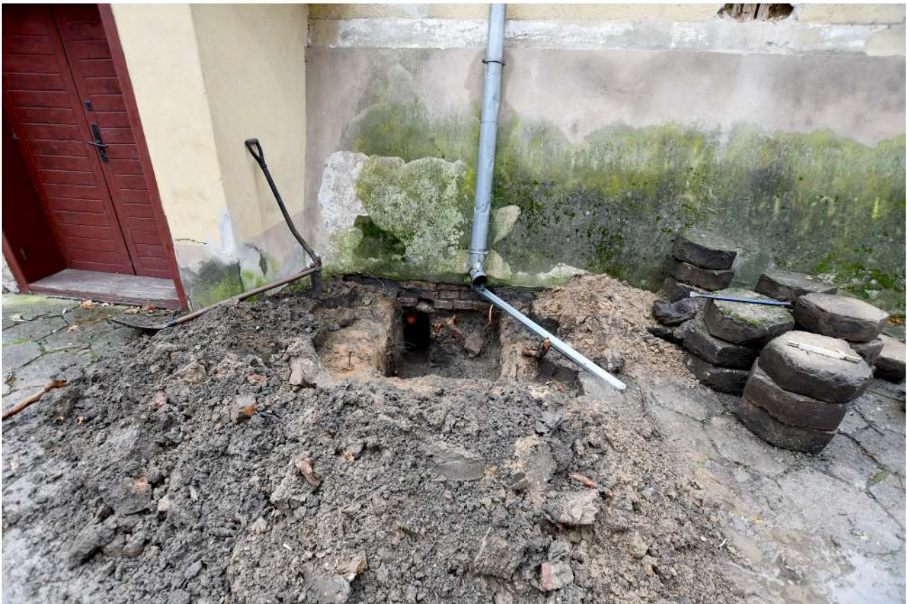
II/2. Oficina dworu starostów międzyrzeckich, wykop sondażowy B pod fundament niepodpiwniczonej części oficyny B
