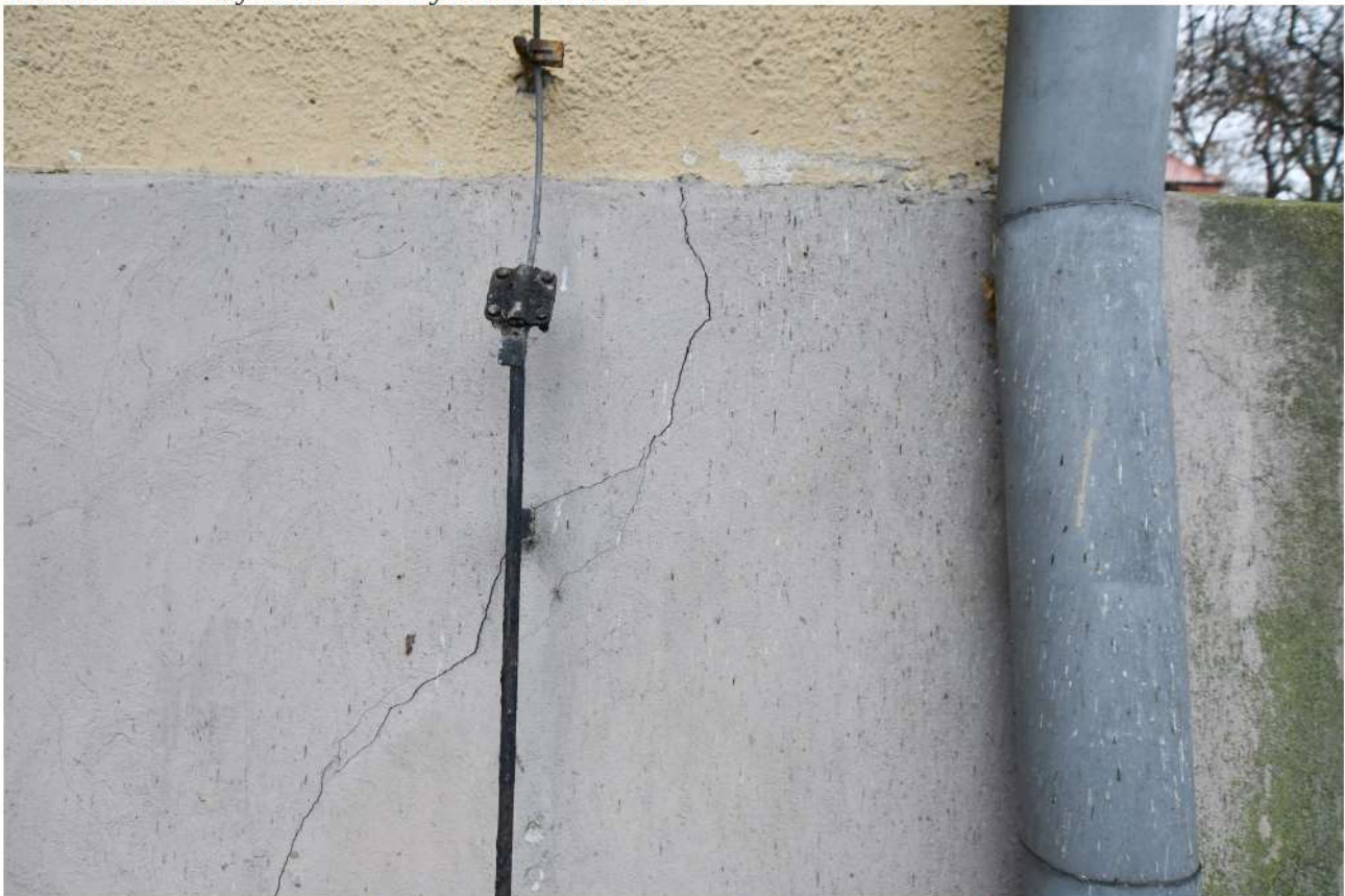
II/8. Oficyna dworu starostów międzyrzeckich, elewacja północno - wschodnia części B oficyny, widoczne wertykalne spękania cokołu spowodowane naporem nasypu skarpy ziemnej
