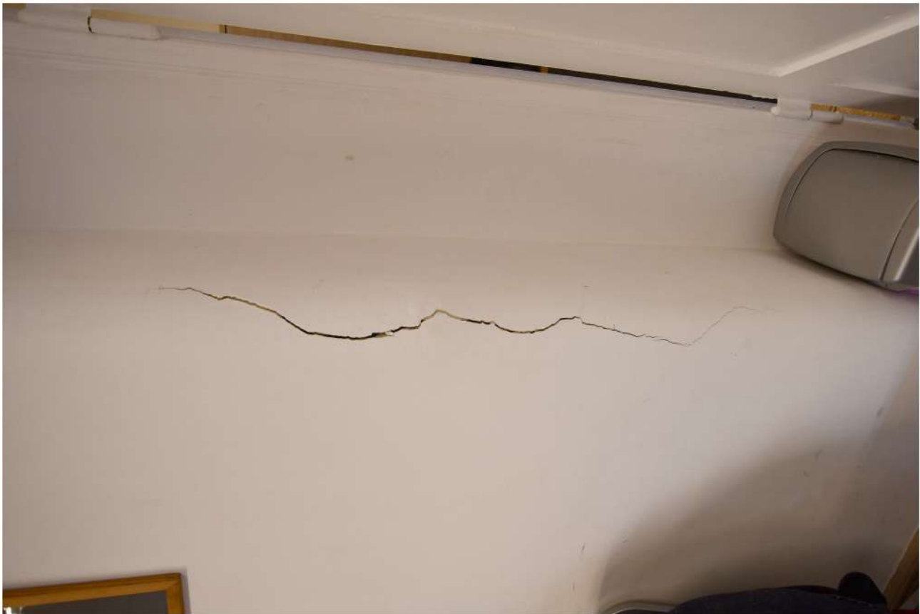
II/11. Oficyna dworu starostów międzyrzeckich, część B, parter, pom. 0/3, widoczne wertykalne pęknięcia tynku na ścianie komina
