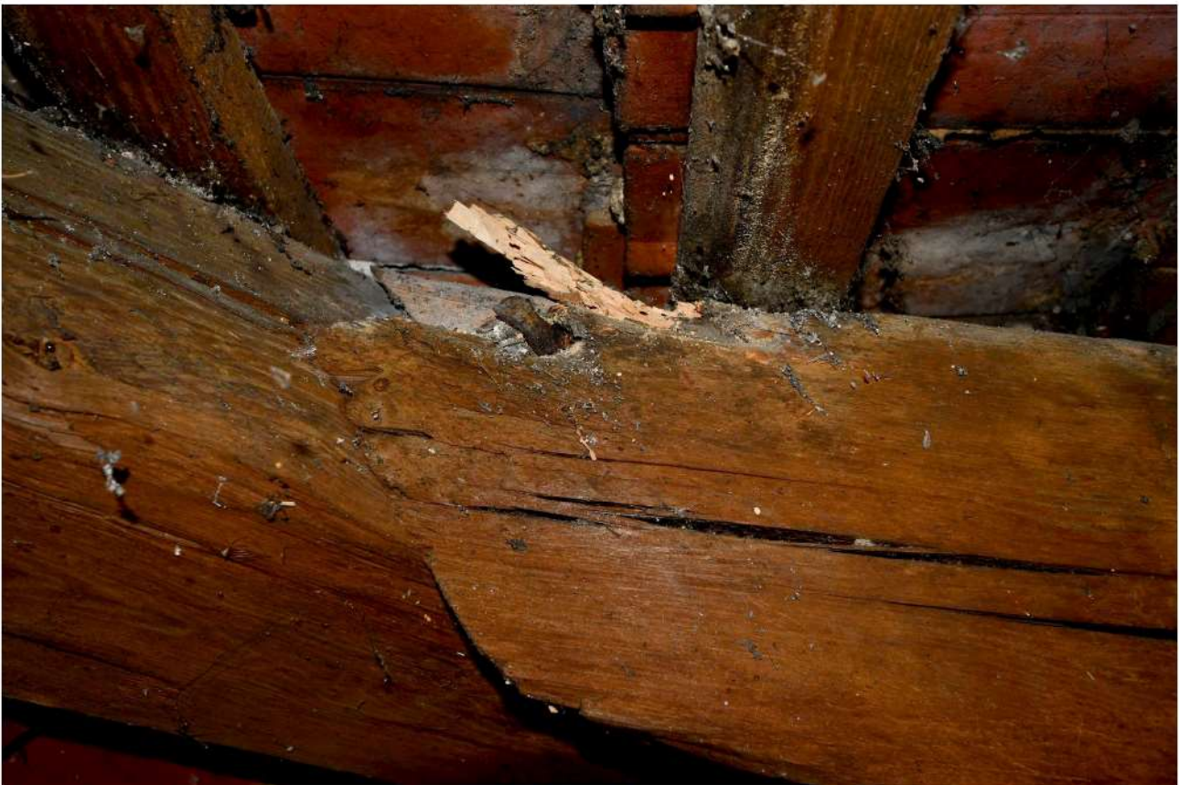
II/16. Oficyna dworu starostów międzyrzeckich, część B, poddasze, pom. 1/2, widoczny ślad uszkodzenia krawędzi krokwi przez spuszczała
