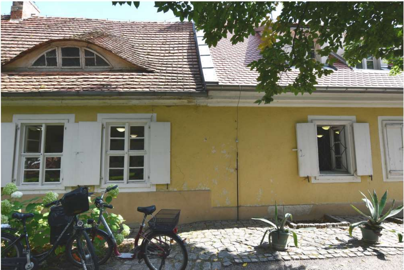
II/7. Oficyna dworu starostów międzyrzeckich, elewacja północno – zachodnia, widok od północnego – zachodu, widoczny styk ścian części B i odtworzonej w latach 60. XX w. części A1, widoczne zróżnicowanie krycia dachu i wysokości cokołu
