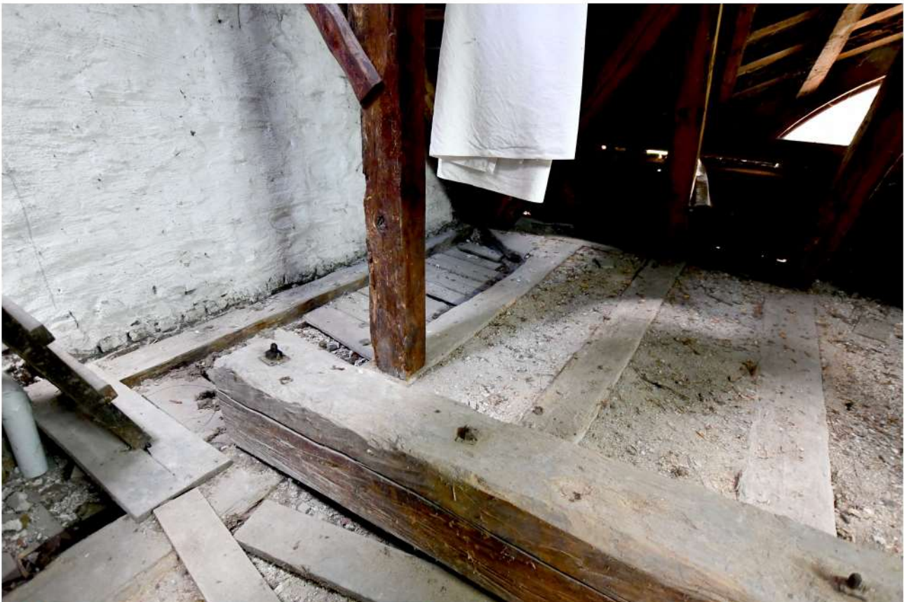
II/14. Oficyna dworu starostów międzyrzeckich, część B, poddasze, pom. 1/3, widoczne odsłonięte belki stropowe, brak podparcia belki nadciągowej oraz oparcie słupa bezpośrednio na belce stropowej
