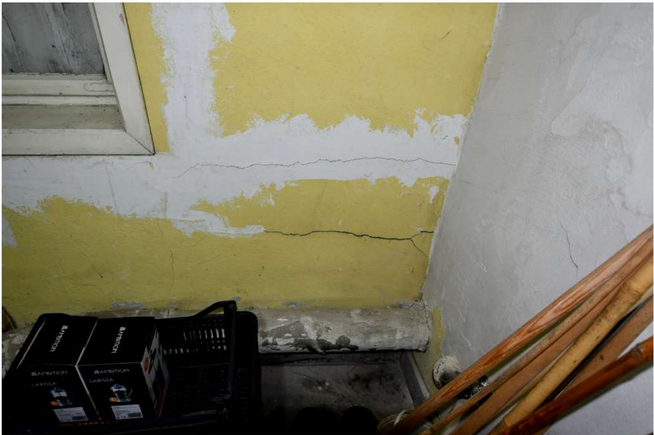
II/12. Oficyna dworu starostów międzyrzeckich, część B, parter, pom. K1, widoczne horyzontalne pęknięcia tynku wokół ukrytej belki konstrukcji szachulcowej na ścianie południowo wschodniej
