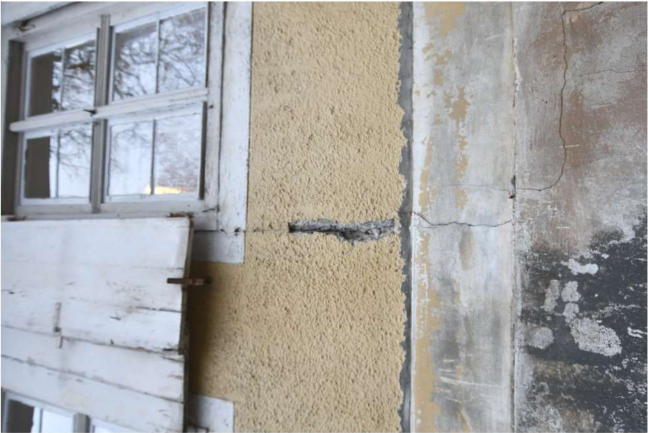
II/5. Oficyna dworu starostów międzyrzeckich, elewacja południowo wschodnia, widoczne pionowe pęknięcie tynku wzdłuż ukrytego słupa konstrukcji szachulcowej oraz poziome spękanie lica skarpy cokołu
