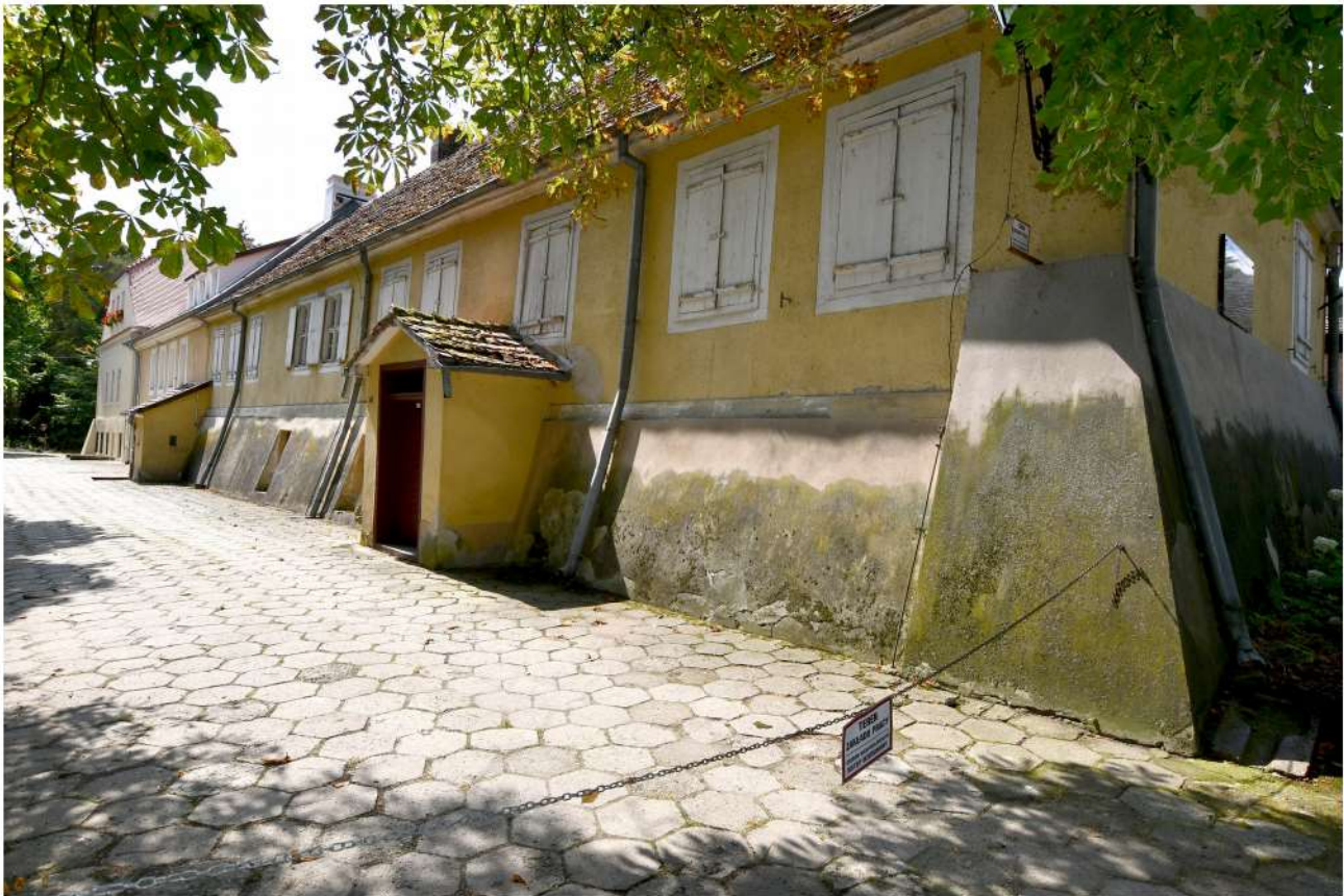
II/9. Oficyna dworu starostów międzyrzeckich, elewacja południowo - wschodnia części B oficyny, widok ogólny od wschodu, widoczne zawilgocenia skarpy
