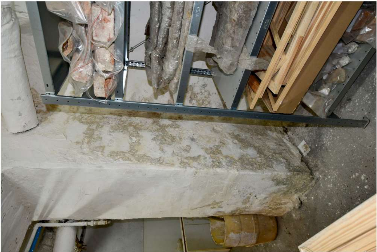
II/17. Oficyna dworu starostów międzyrzeckich, część A1, piwnice, pom.01/6, widoczne zawilgocenia tynków ściany poprzecznej z przejściem do pom. 01/9
