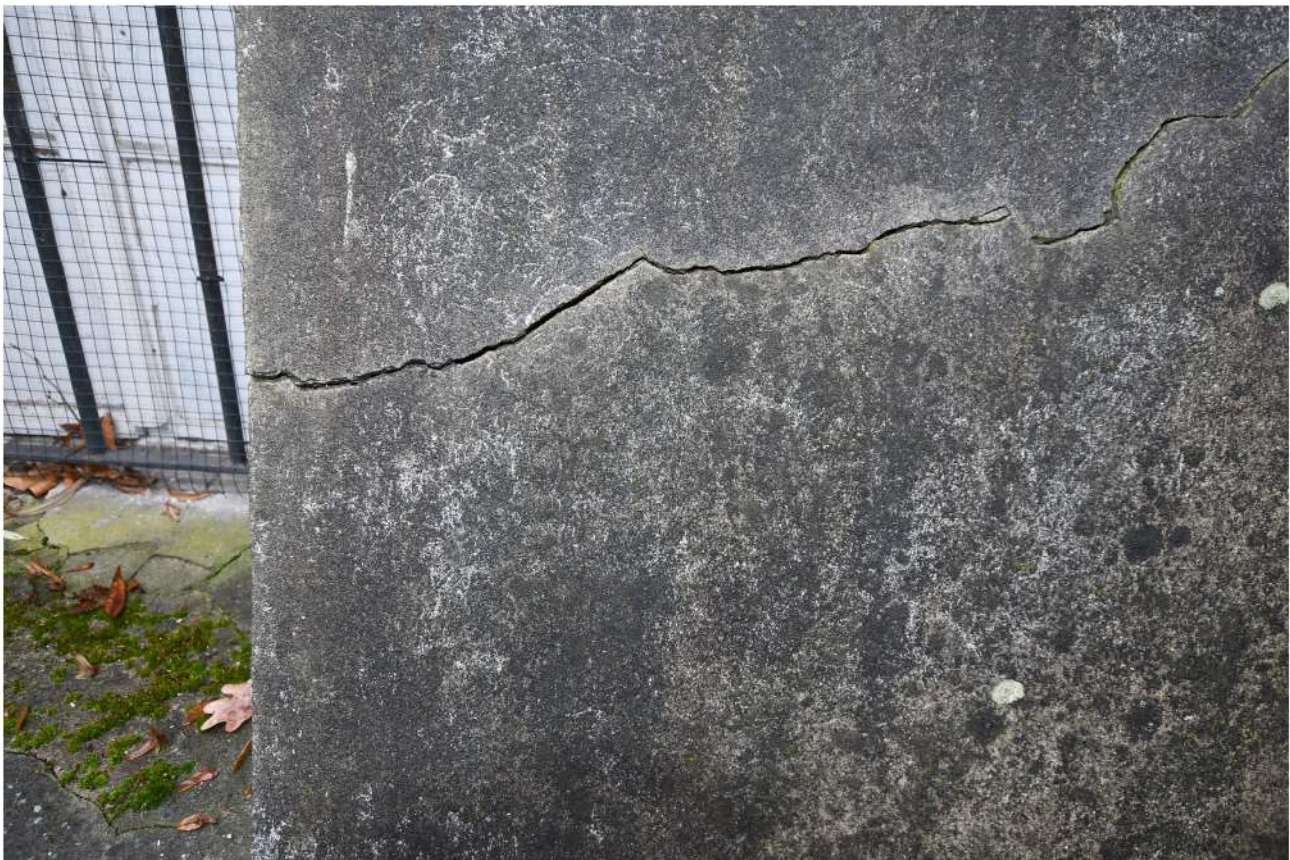
II/10. Oficyna dworu starostów międzyrzeckich elewacja południowo - wschodnia części A1 oficyny, widoczne horyzontalne pęknięcie cokołu przedsionka do pom. 0/14 – kotłowni
