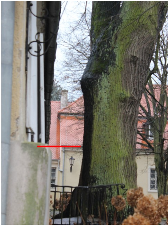
Ryc. 6. Niewielka odległość pnia od ściany budynku (1.1m).
