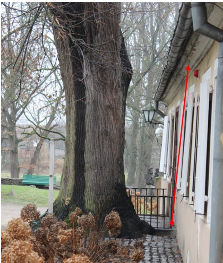
Ryc. 8. Konflikt podnoszenie przez korzenie ściany frontowej budynku
