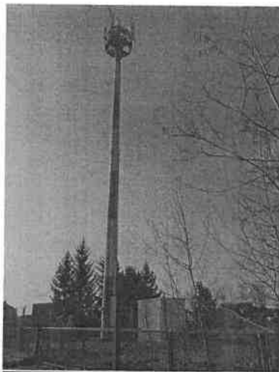
Zał. nr 1: Widok ogólny instalacji radiokomunikacyjnej.
