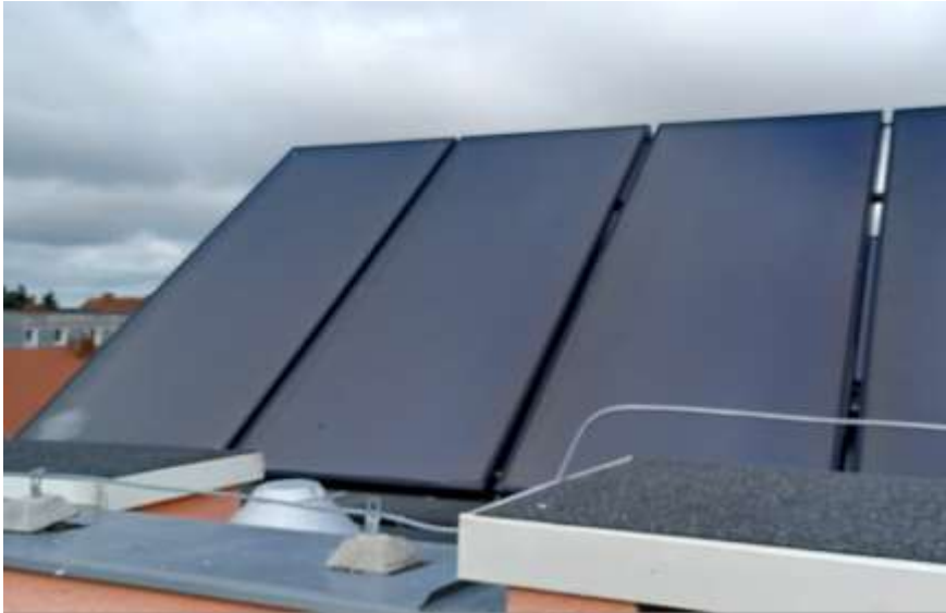
Zdjęcie 12 Kolektory słoneczne na budynku ZOL w Lubusku
