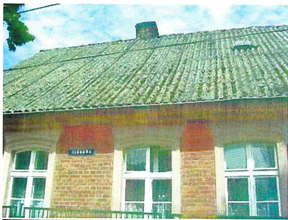
Rysunek 6 Pokrycie dachu eternitem
