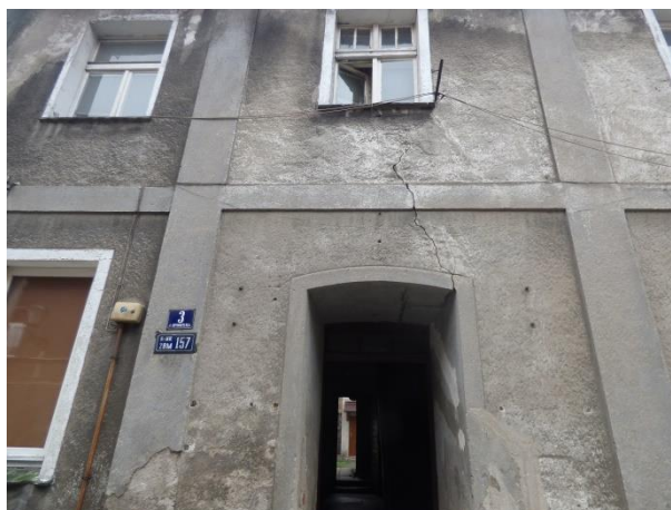
Fot. 1. Przykład kamienicy, która wymaga prac remontowych
