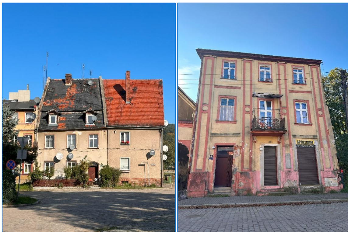
Ryc. 17 Budynki mieszkalne wymagające remontu na obszarze rewitalizacji: ul. Wodna i ul. Pocztowa
