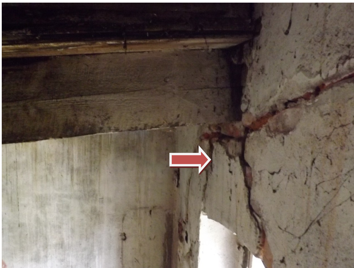
( Zdjęcie Nr 25.Uszkodzenie nadproża ) .
