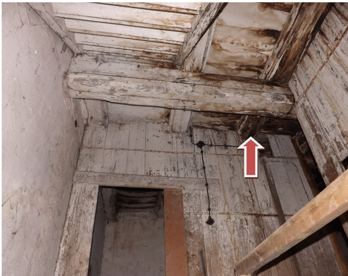
( Zdjęcie Nr 16. Klatka schodowa – degradacja biologiczna elementów konstrukcyjnych) .
