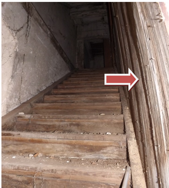
( Zdjęcie Nr 14. Widok stopni schodowych – degradacja biologiczna ).
