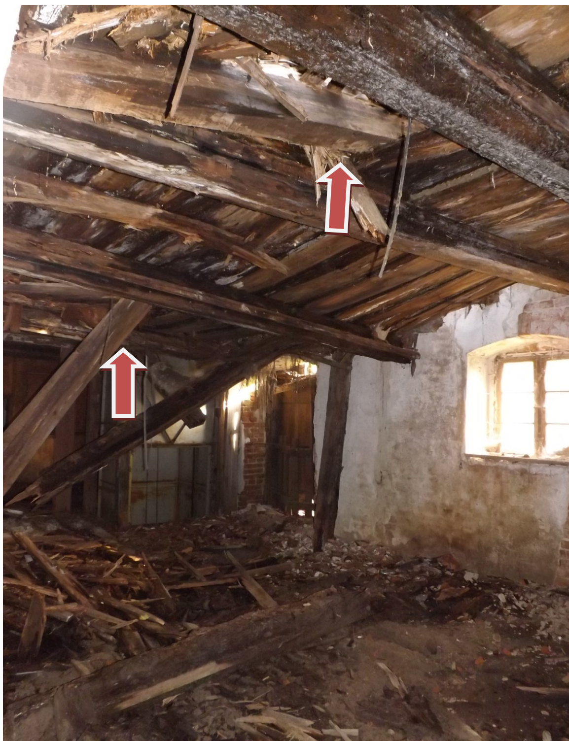
( Zdjęcie Nr 19. Pomieszczenie magazynowe – widok skutków awarii dachu ) .
