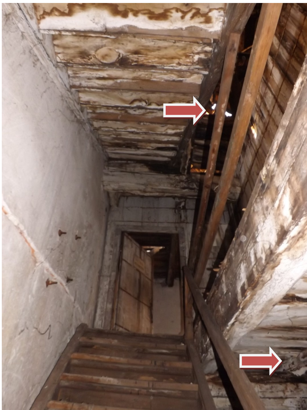
( Zdjęcie Nr 21. Widok wejścia na poddasze – korozja biologiczna elementów konstrukcyjnych stropu wraz z skutkami awarii dachu ) .
