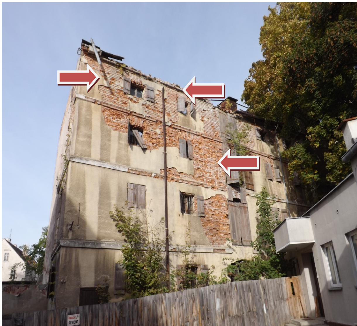
( Zdjęcie Nr 7. Widok ogólny budynku – widoczne uszkodzenia dachu , gzymsu oraz korozji biologicznej materiałów ).
