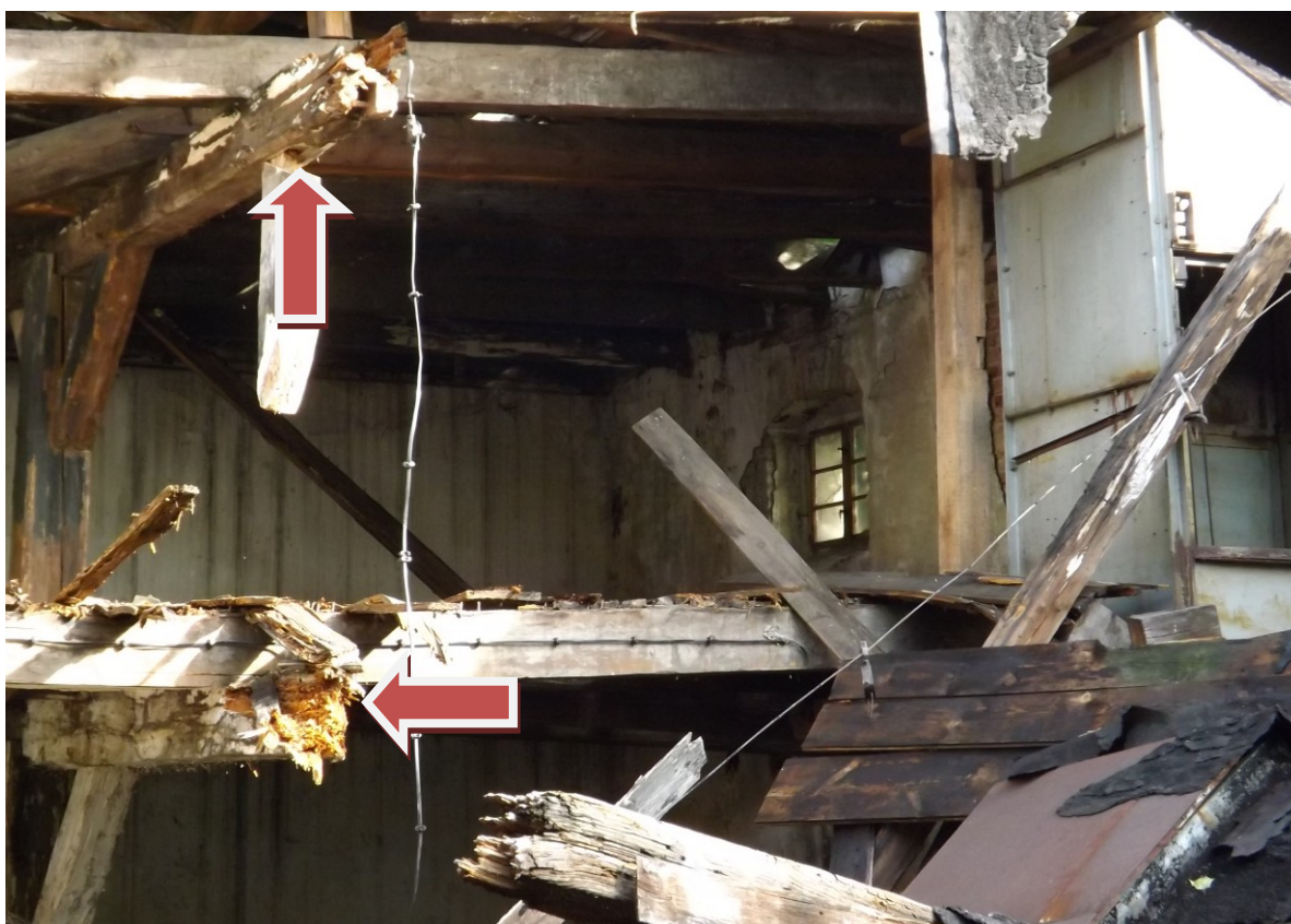
( Zdjęcie Nr 23. Widok awarii dachu – uszkodzone belki główne konstrukcji dachu ).
