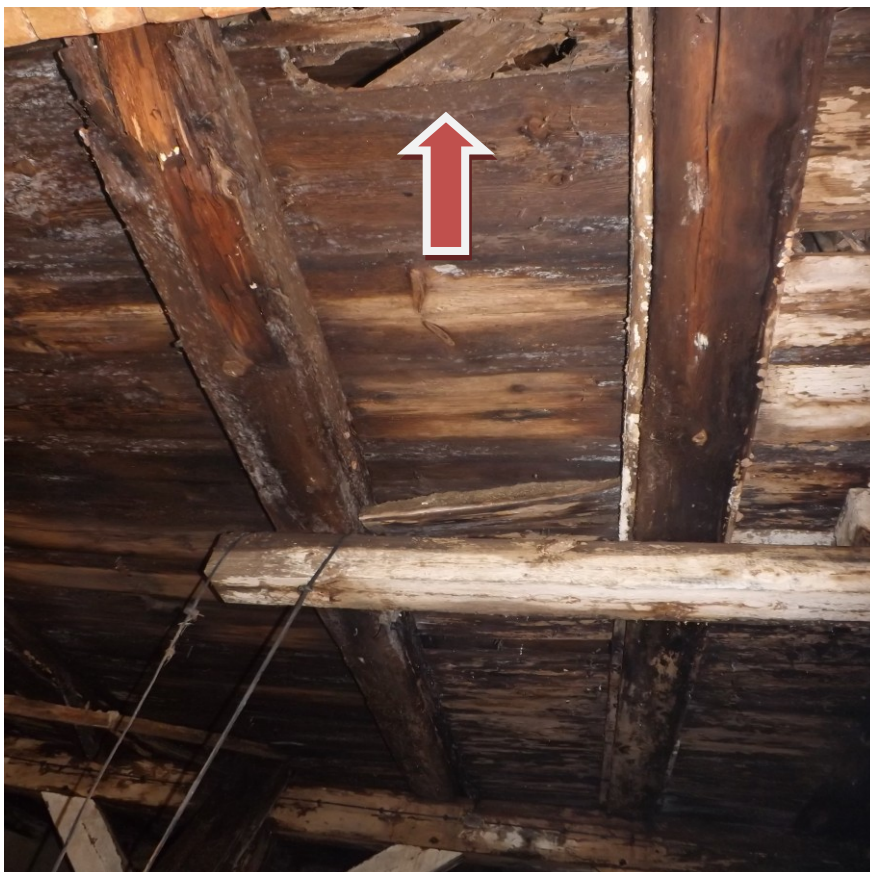
( Zdjęcie Nr 9. Strop piętra – widoczna korozja biologiczna wypełniania stropu ).
