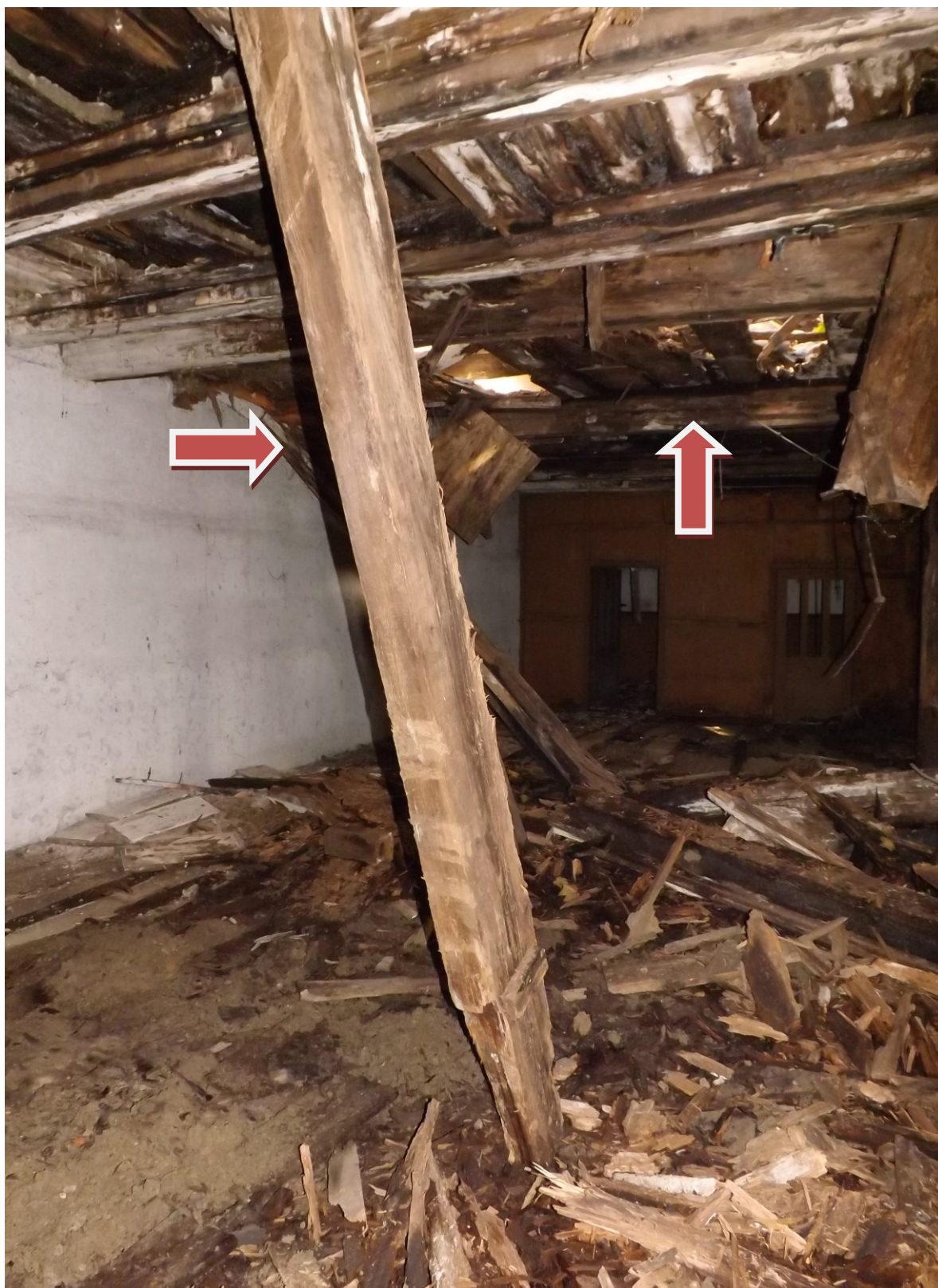
( Zdjęcie Nr 18. Pomieszczenie magazynowe – piętro ; widok zużycia stropu poddasza wraz z uszkodzeniami głównych belek stropowych ) .
