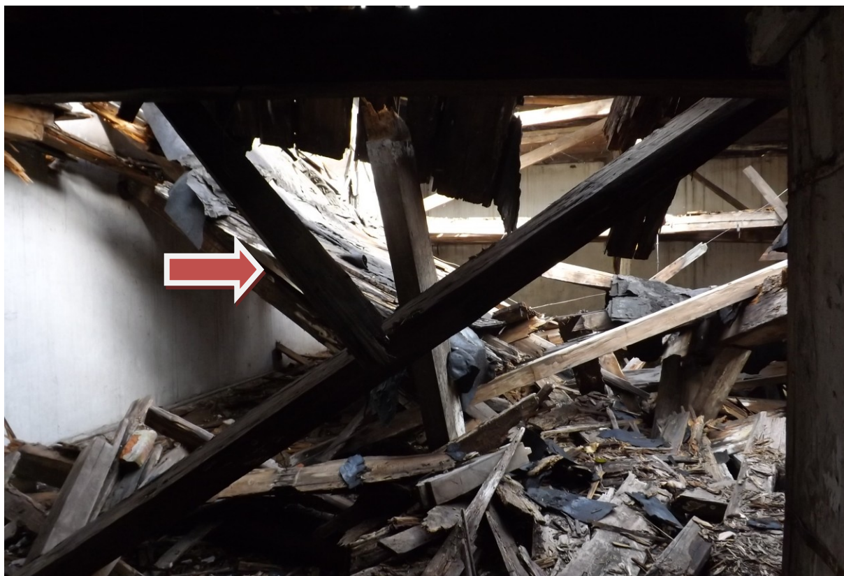
( Zdjęcie Nr 22. Widok po awarii dachu uszkodzone elementy konstrukcyjne więźby dachowej ).
