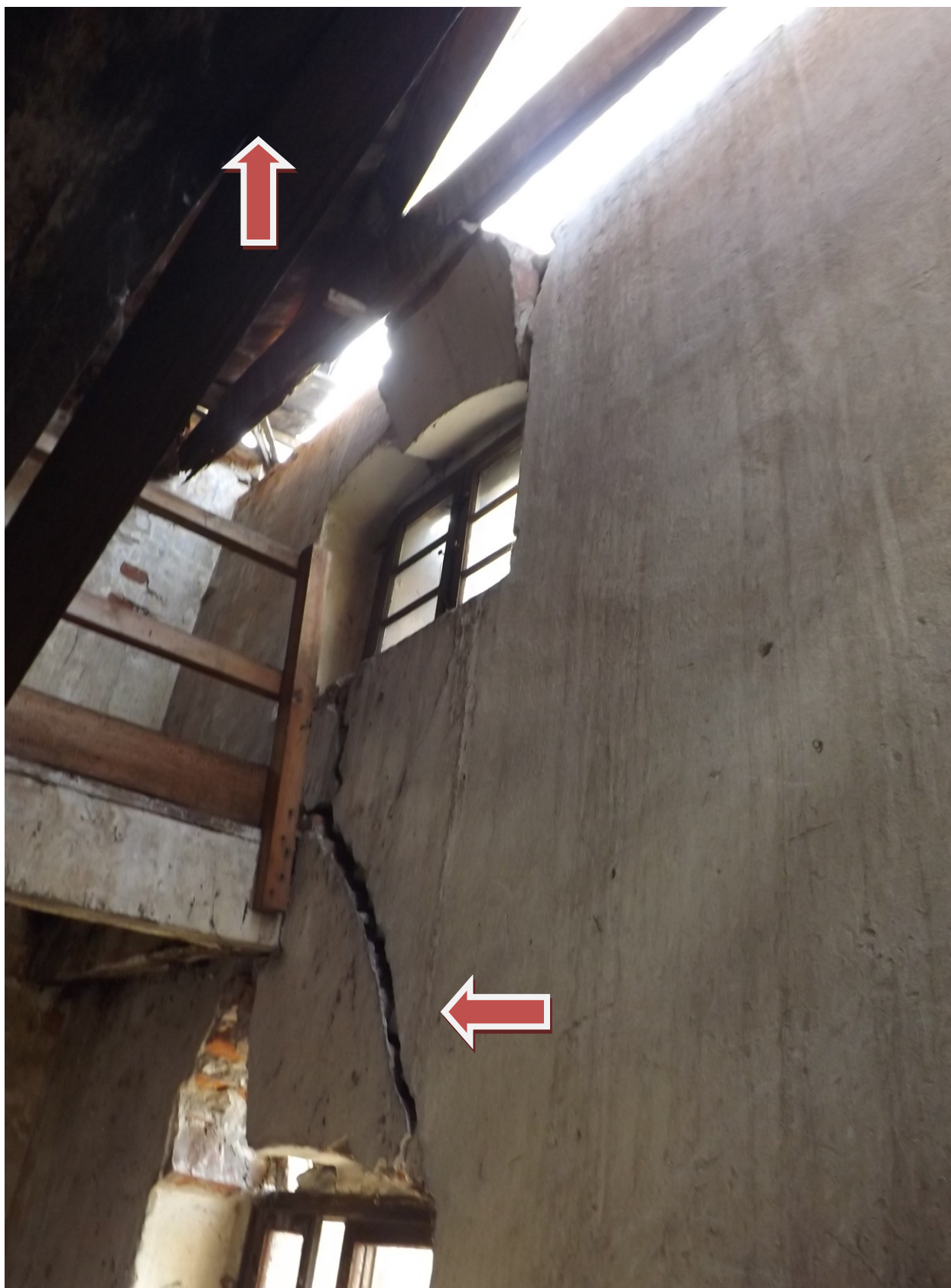
( Zdjęcie Nr 24. Uszkodzenia muru oraz nadproży – ścian nośnych budynku ).
