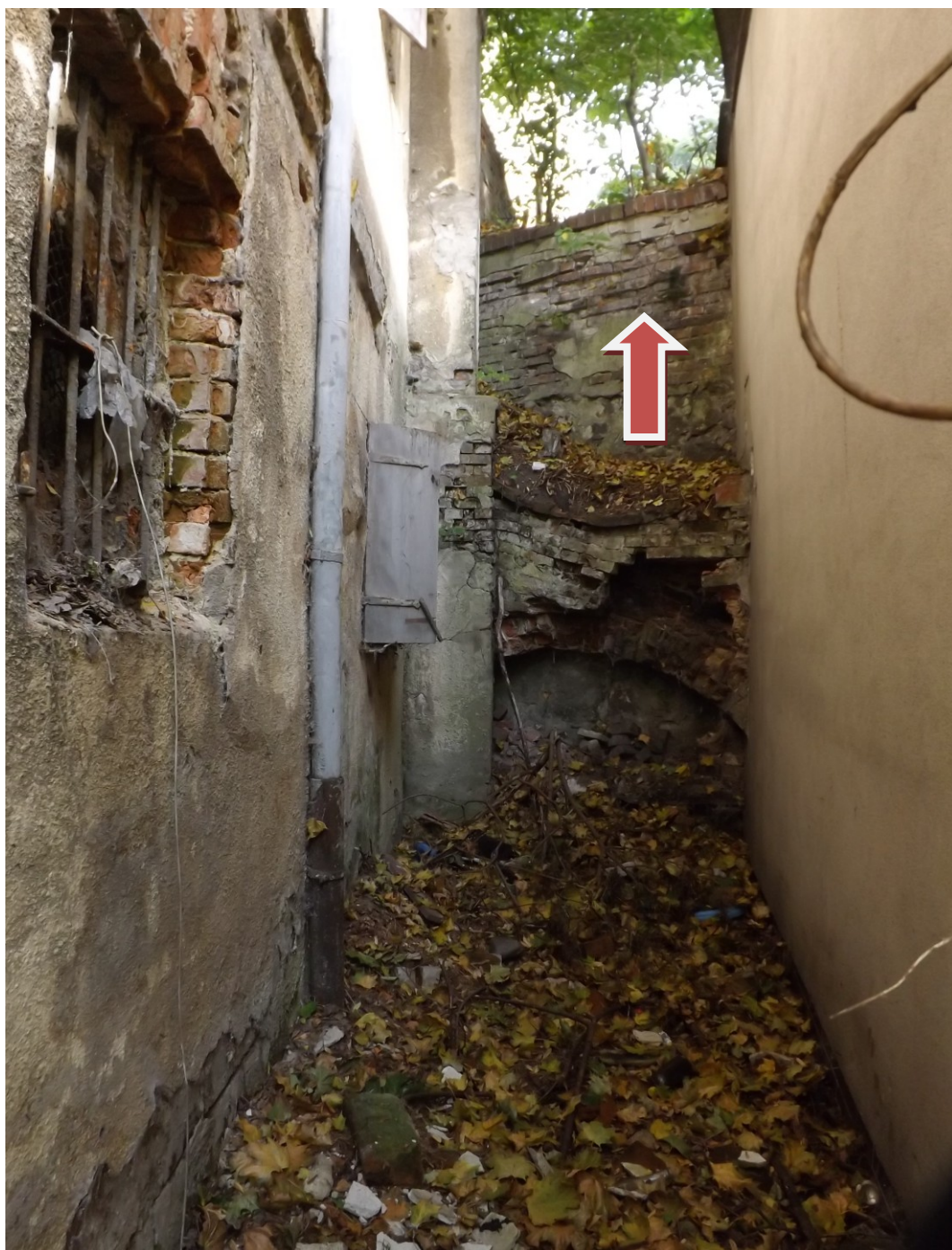
( Zdjęcie Nr 5. Istniejący stary mur oporowy od strony ul. WOP ).
