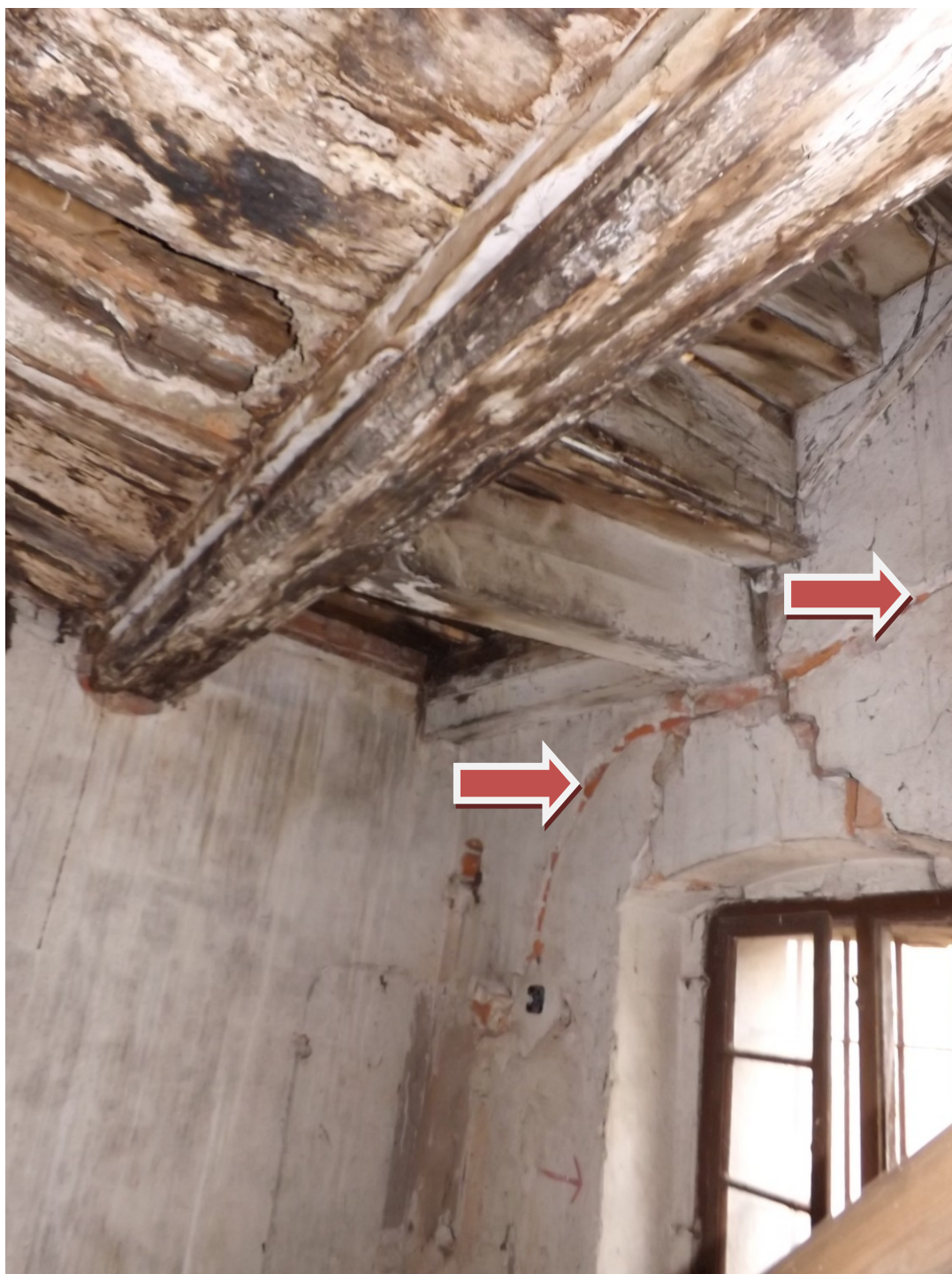
( Zdjęcie Nr 20. Uszkodzenia muru wywołane w skutek awarii dachu ) .
