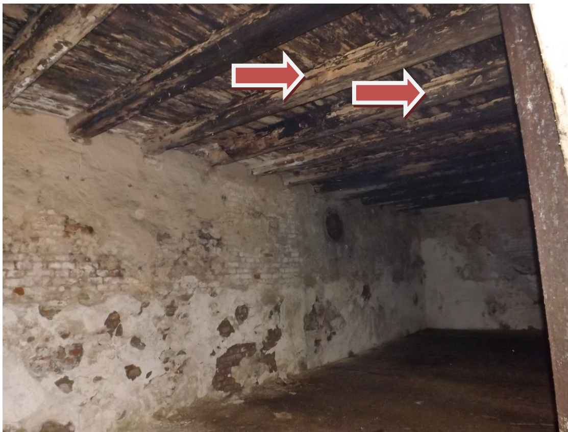
(Zdjęcie Nr 11. Strop parteru – układ belek głównych stropu wraz z widocznym biologicznym uszkodzeniem).
