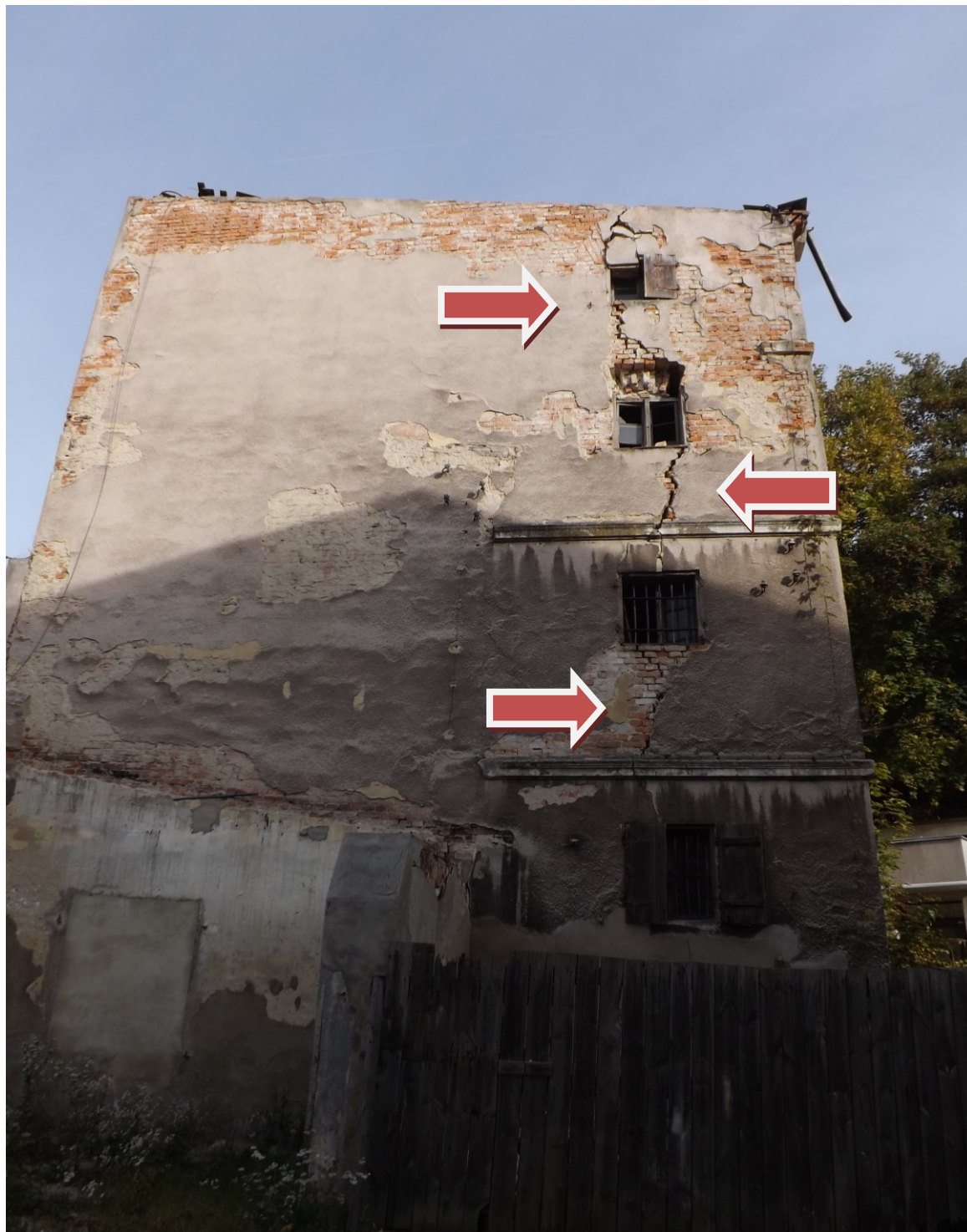
( Zdjęcie Nr 6. Widoczne spękania pionowe muru wywołane awarią dachu ).
