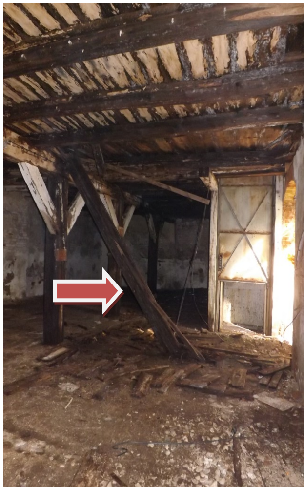
( Zdjęcie Nr 15. Ogólny widok pomieszczenia parteru – degradacja biologiczna elementów konstrukcyjnych ).
