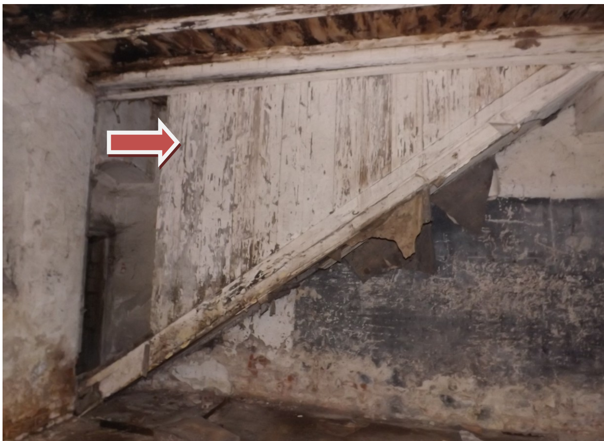
( Zdjęcie Nr 13. Schody wejściowe na piętro- widoczna korozja biologiczna ).
