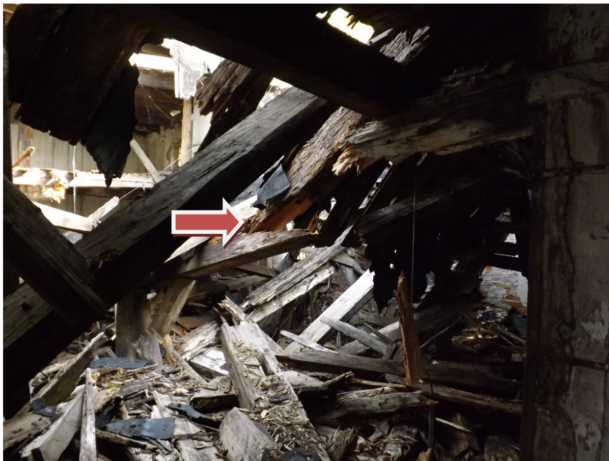
( Zdjęcie Nr 23. Widok po awarii dachu ).
