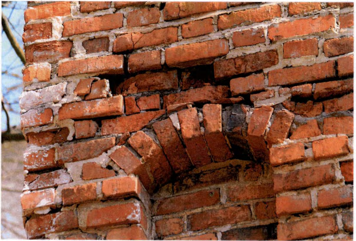
FOT. 27 - Ściana zachodnia, strona zewnętrzna, zwieńczenie w narożniku wschodnim – widoczne współczesna, cementowa zaprawa murarska i wykruszająca się cementowo-wapienna zaprawa spoinująca.
