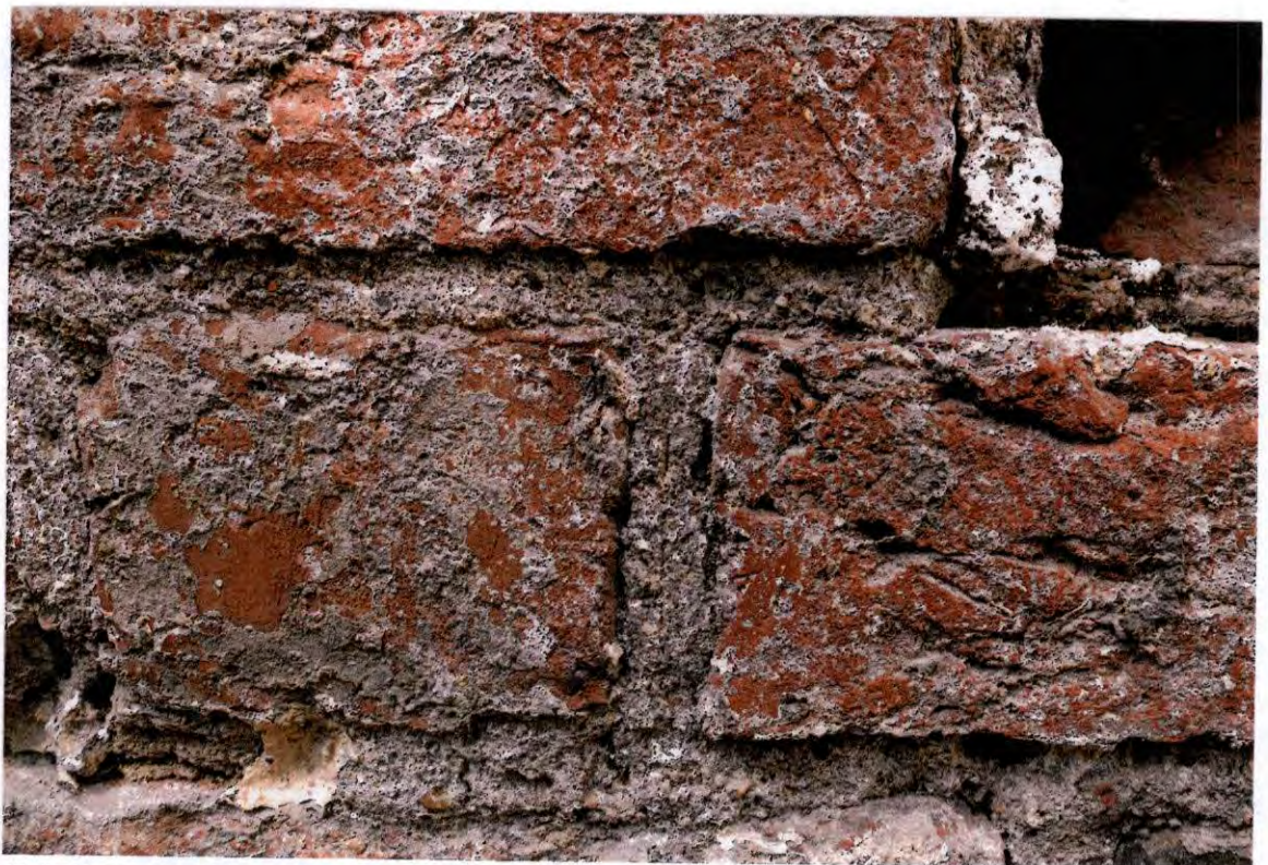
FOT. 10 - Ściana południowa strona zewnętrzna, odcinek w strefie przyziemia – zachowany relikwit oryginalnej warstwy powierzchniowej spoiny ciętej.
