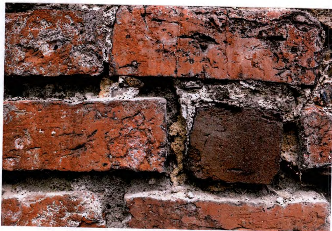
FOT. 8 - Ściana południowa strona zewnętrzna, odcinek wschodni – zniszczenia i rozwarstwienie zapraw spoinujących.
