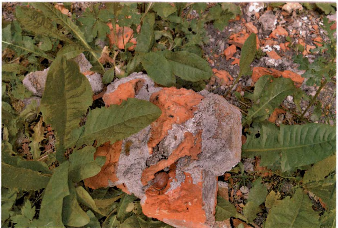
FOT. 28 - Ściana zachodnia, strona zewnętrzna – fragment uszkodzonego zwieńczenia muru leżący na trawniku przyległego terenu.
