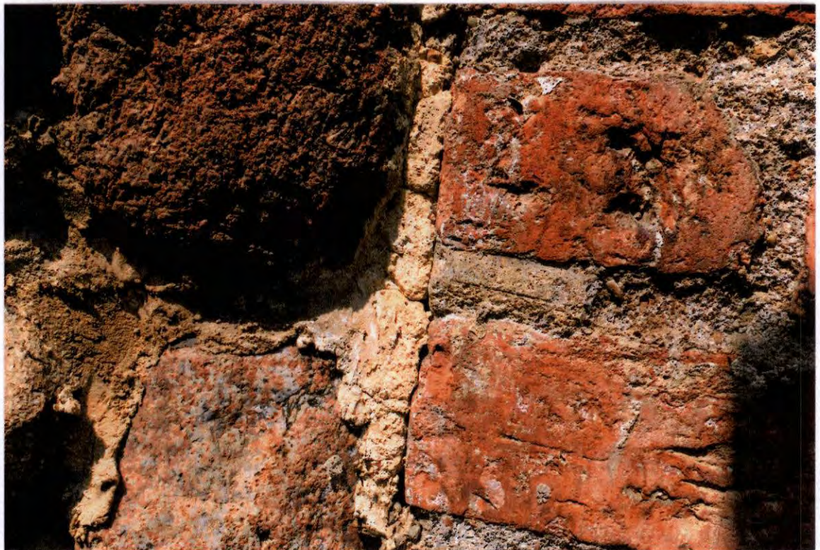
FOT. 12 - Ściana południowa strona zewnętrzna, odcinek narożny zachodni przy murze fragmentu obecnego ogrodzenia - zachowany relikwiarz oryginalnej warstwy powierzchniowej spoiny ciętej.
