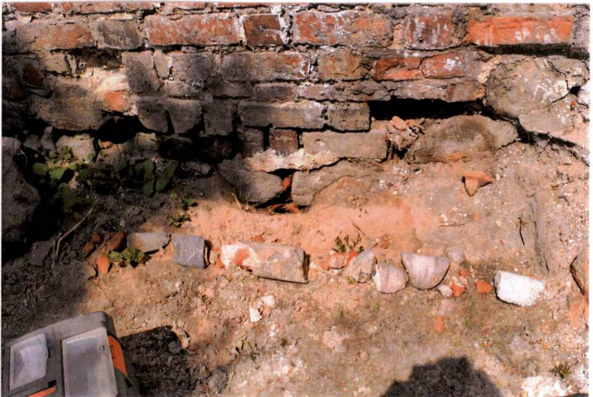
FOT. 4 - Ściana południowa strona zewnętrzna, odcinek wschodni przy podstawie z widocznymi fragmentami rdzenia przewiertu geotechnicznego.
