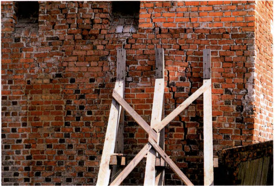
FOT. 19 - Ściana zachodnia, strona zewnętrzna – fragment narożny, południowy z tymczasowym stemplowaniem pękniętego fragmentu.
