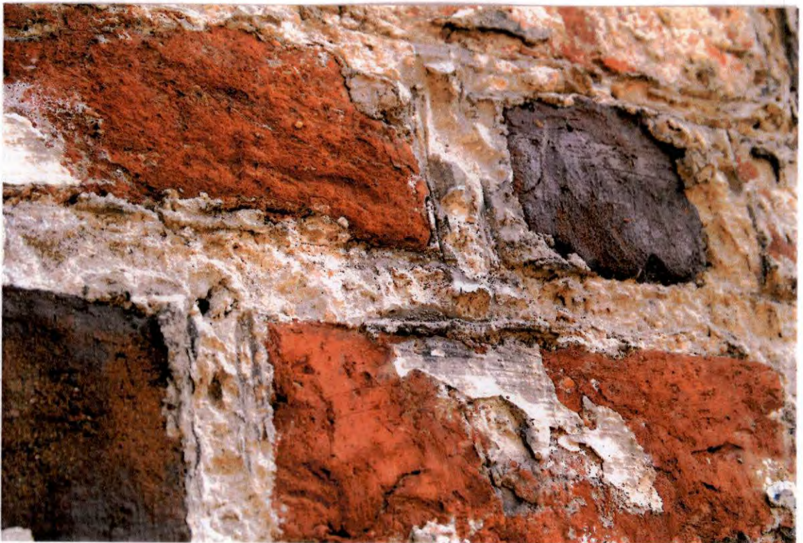
FOT. 23, 24 - Ściana zachodnia, strona zewnętrzna, fragmenty z charakterystycznymi dla tej ściany zniszczeniami nawarstwień wtórnego spoinowania muru, pobiał i zacierek tynkarskich na powierzchniach wątku ceramicznego.
