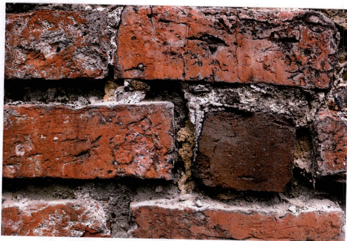
FOT. 8 - Ściana południowa strona zewnętrzna, odcinek wschodni – zniszczenia i rozwarstwienie zapraw spoinujących.
