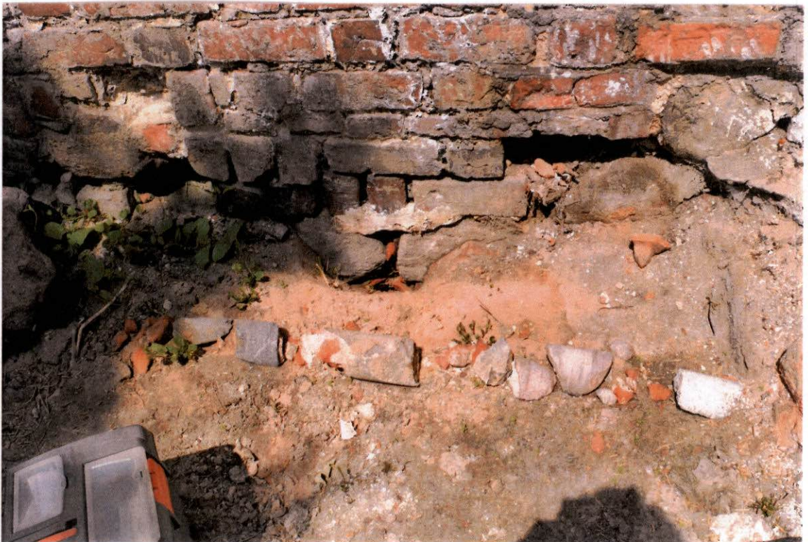
FOT. 4 - Ściana południowa strona zewnętrzna, odcinek wschodni przy podstawie z widocznymi fragmentami rdzenia przewiertu geotechnicznego.
