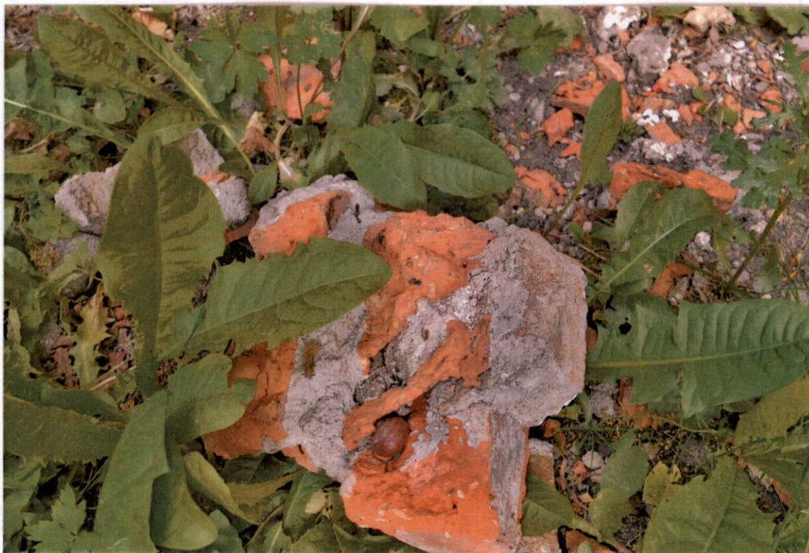
FOT. 28 - Ściana zachodnia, strona zewnętrzna – fragment uszkodzonego zwieńczenia muru leżący na trawniku przyległego terenu.
