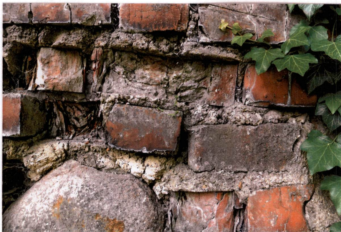
FOT. 33, 34 - Ściana południowa, strona wewnętrzna, fragmenty charakterystycznych zniszczeń lica murowanego na sztywnej, cementowej zaprawie murarskiej.
