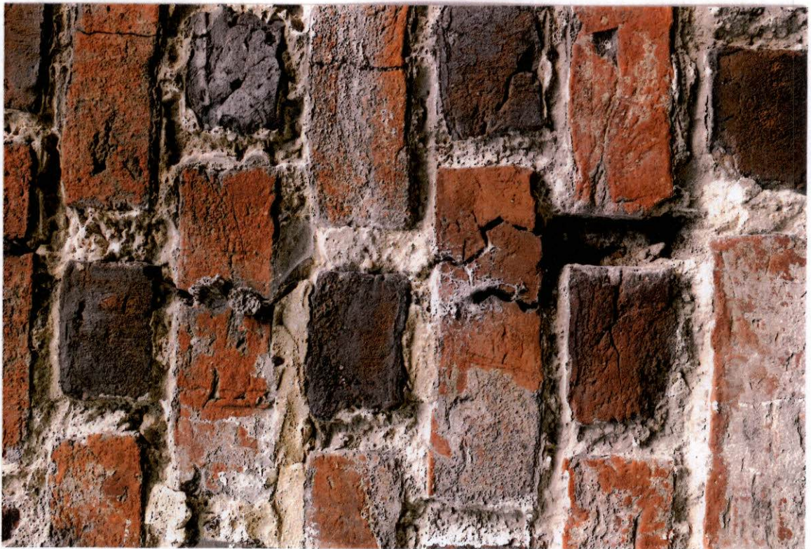
FOT. 22 - Ściana zachodnia, strona zewnętrzna, miejsce pobrania próbki nr 8
