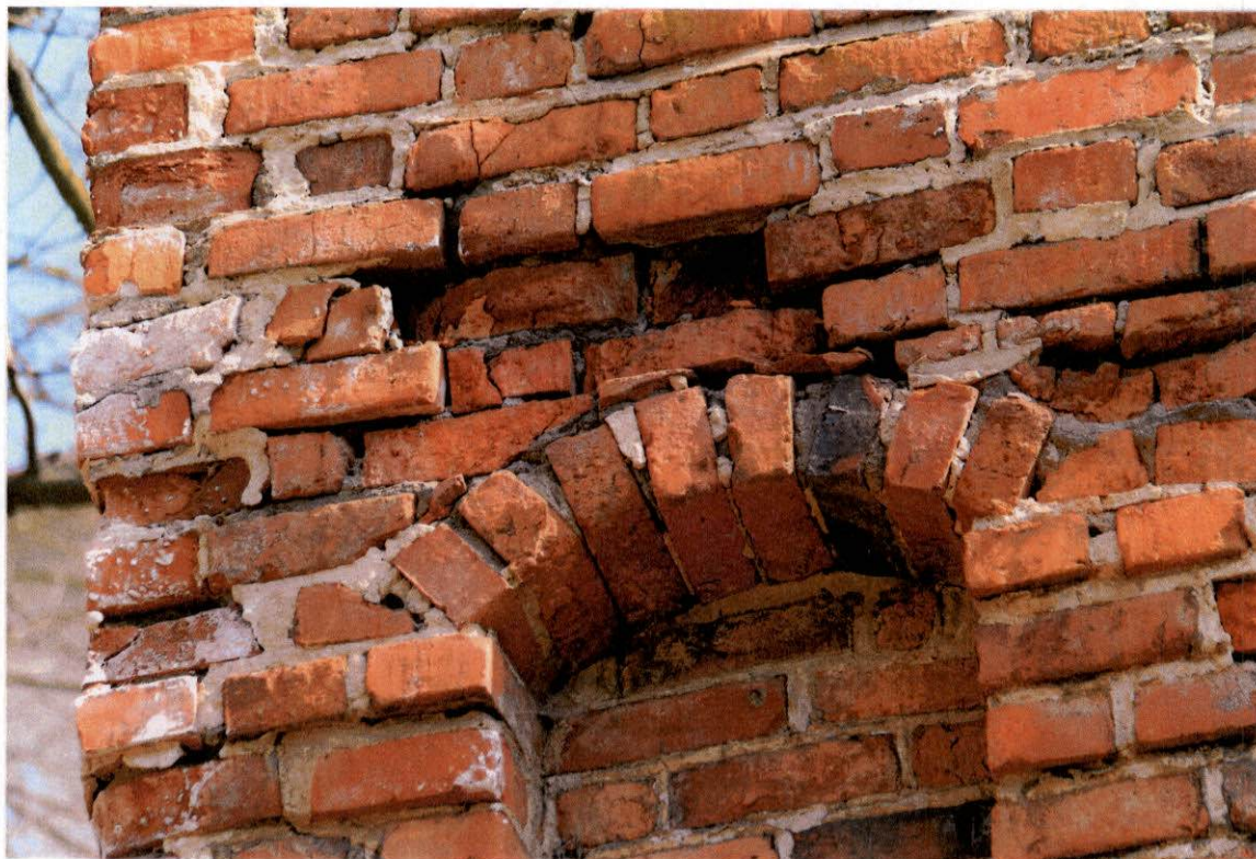
FOT. 27 - Ściana zachodnia, strona zewnętrzna, zwieńczenie w narożniku wschodnim – widoczne współczesna, cementowa zaprawa murarska i wykruszająca się cementowo-wapienna zaprawa spoinująca.
