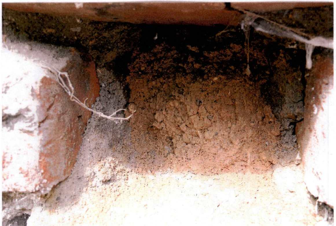
FOT. 13, 14 - Ściana południowa strona zewnętrzna, odcinek zachodni – fragmenty wypełnienia zaprawą w miejscu ubytku cegły. Wypełnienie tynkiem barwy kremowo ugrowej w otoczeniu zaprawy wapiennej barwy szarej.
