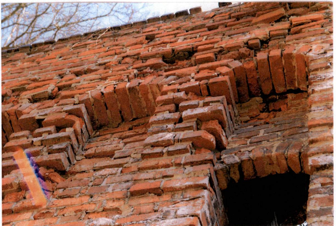
FOT. 25, 26 - Ściana zachodnia, strona zewnętrzna – uszkodzenia w strefie zwieńczenia muru.
