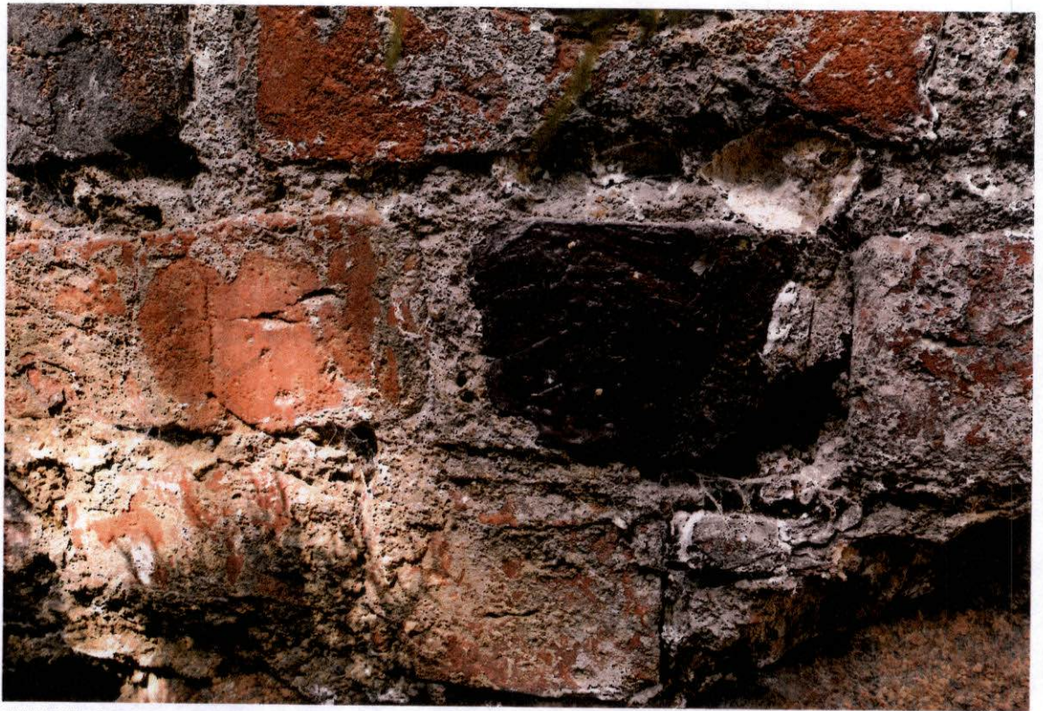
FOT. 9 - Ściana południowa strona zewnętrzna, odcinek środkowy przyziemie - fragment powierzchni zaprawy z widocznym oryginalnym opracowaniem powierzchni.
