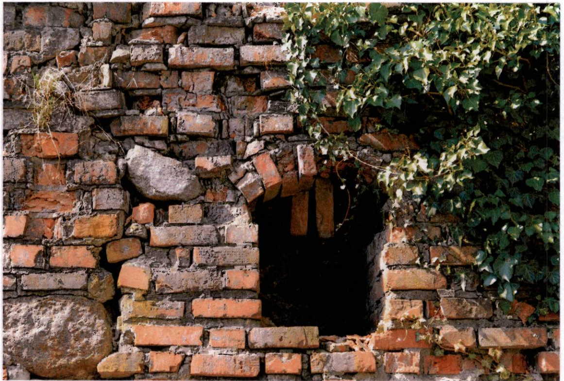
FOT. 31 - Ściana zachodnia, strona wewnętrzna , fragment – pęknięcie muru, liczne uszkodzenia
