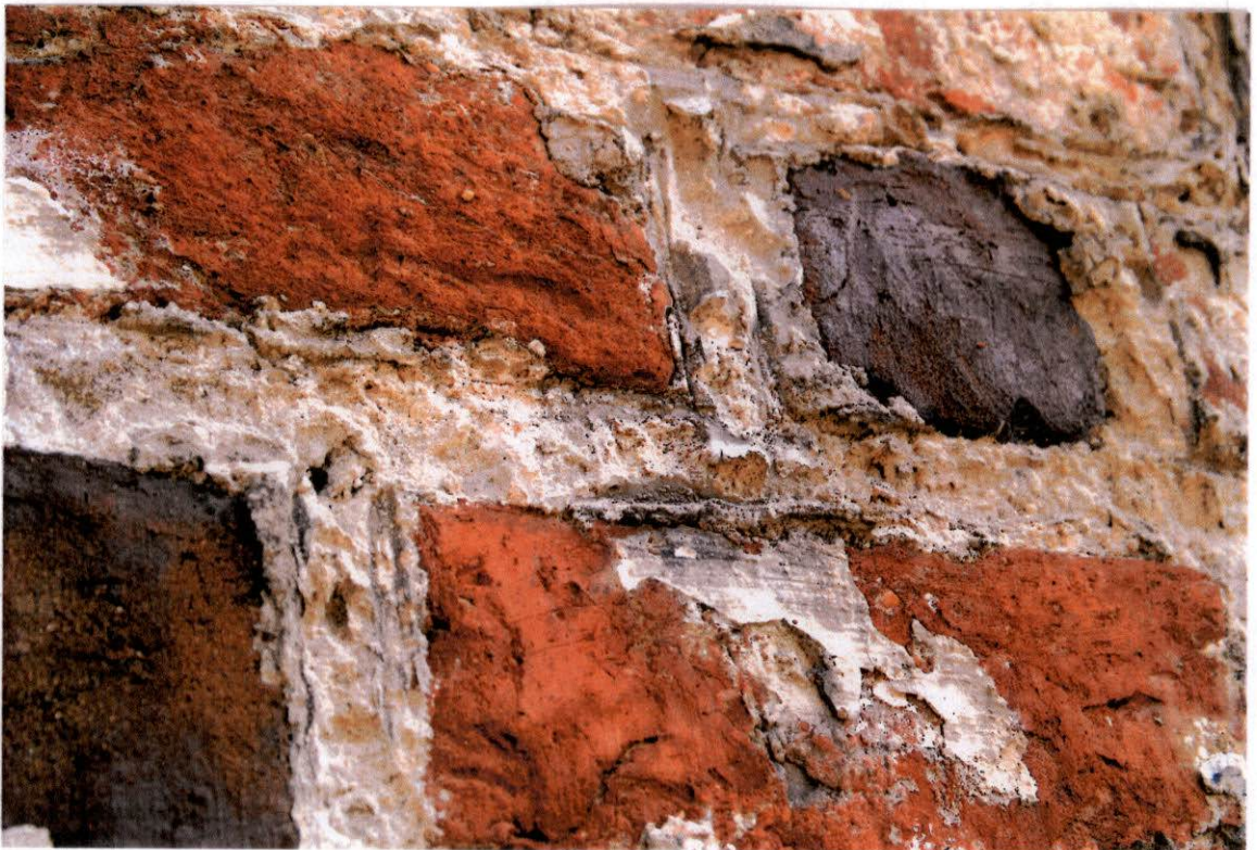
FOT. 23, 24 - Ściana zachodnia, strona zewnętrzna, fragmenty z charakterystycznymi dla tej ściany zniszczeniami nawarstwień wtórnego spoinowania muru, pobiał i zacierek tynkarskich na powierzchniach wątku ceramicznego.
