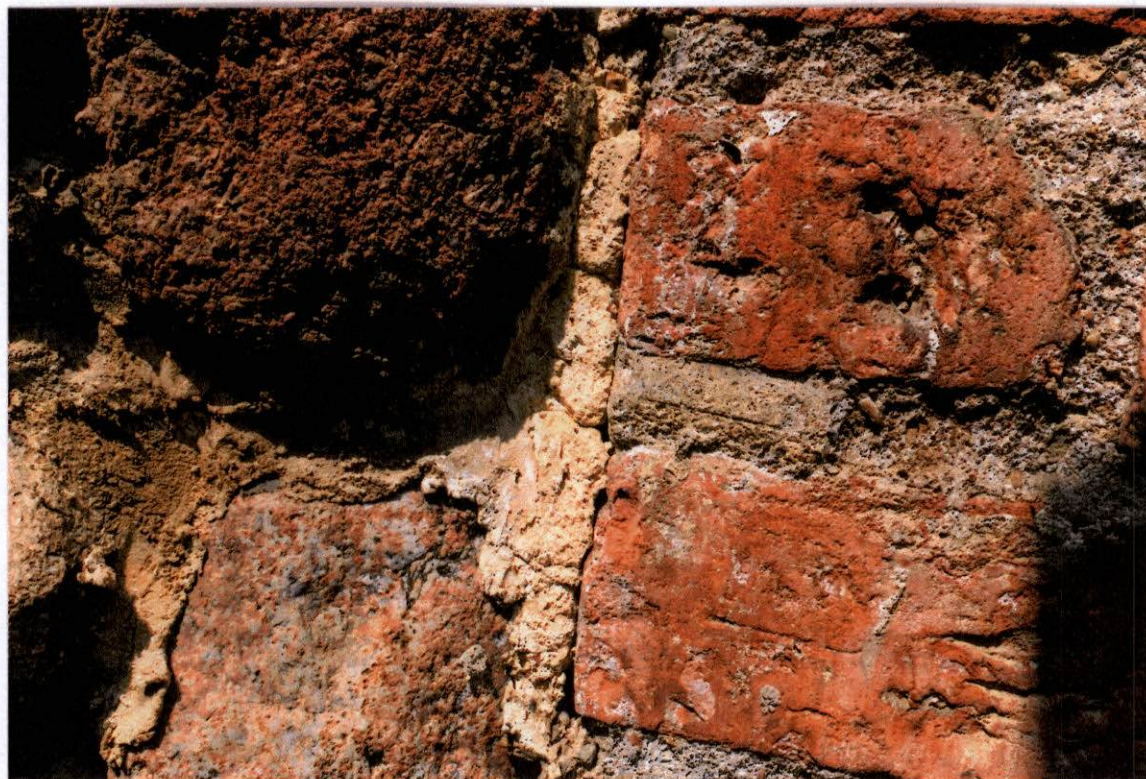
FOT. 12 - Ściana południowa strona zewnętrzna, odcinek narożny zachodni przy murze fragmentu obecnego ogrodzenia – zachowany relikwit oryginalnej warstwy powierzchniowej spoiny ciętej.
