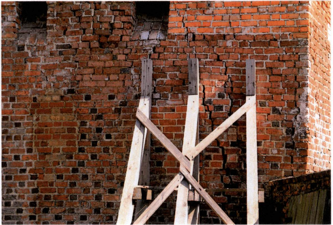
FOT. 19 - Ściana zachodnia, strona zewnętrzna – fragment narożny, południowy z tymczasowym stemplowaniem pękniętego fragmentu.
