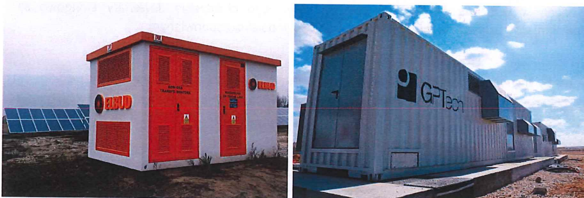
Rysunek 27. Stacja transformatorowa
