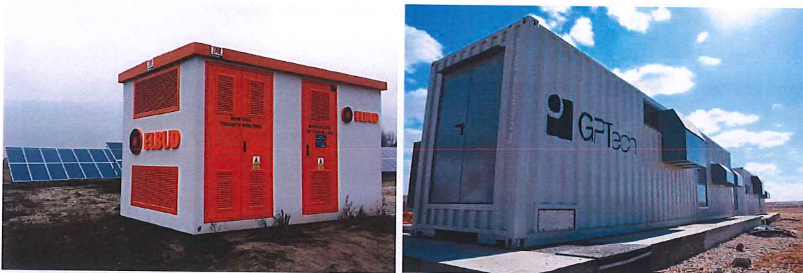
Rysunek 27. Stacja transformatorowa
