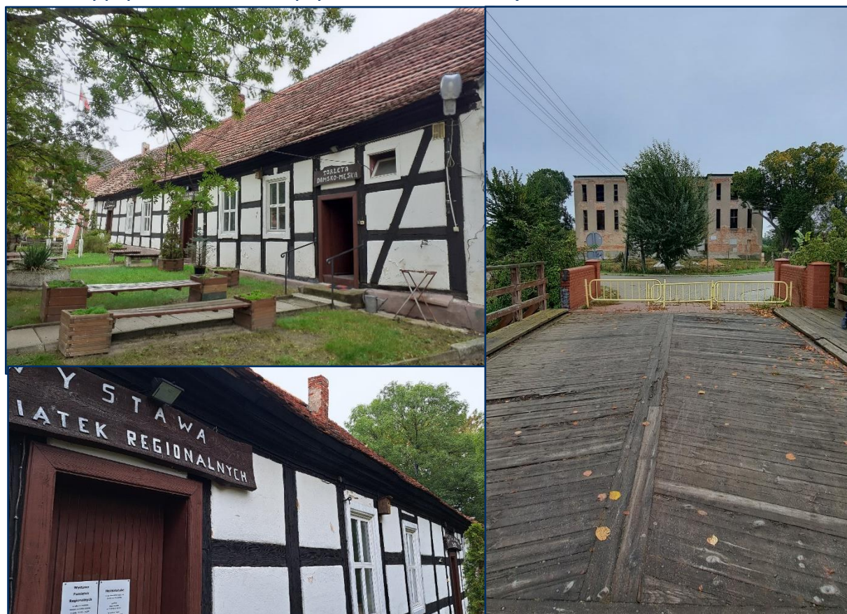
Rysunek 16. Zdegradowane obiekty w granicach podobszaru rewitalizacji Słońsk 1 (od lewej strony: budynek szachulcowy przy Placu Wolności, most przy ruinach Zamku Joannitów).
