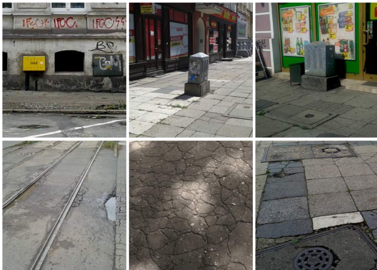
Ryc. 19. Zły stan technicznej infrastruktury drogowej
