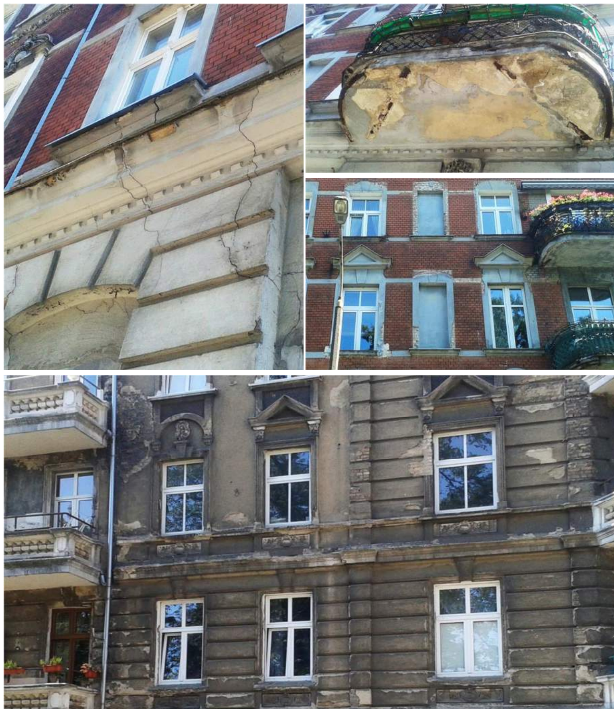
Ryc. 26. Faktyczny stan techniczny przykładowych budynków „w stanie dobrym”: przykład Łokietka 29 – prawdopodobnie konieczność natychmiastowego remontu kapitalnego
