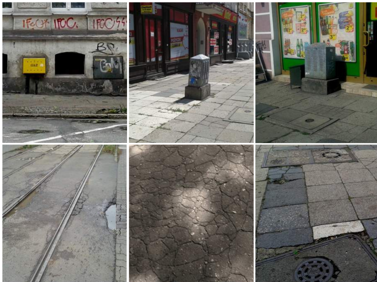
Ryc. 36. Zły stan technicznej infrastruktury drogowej
