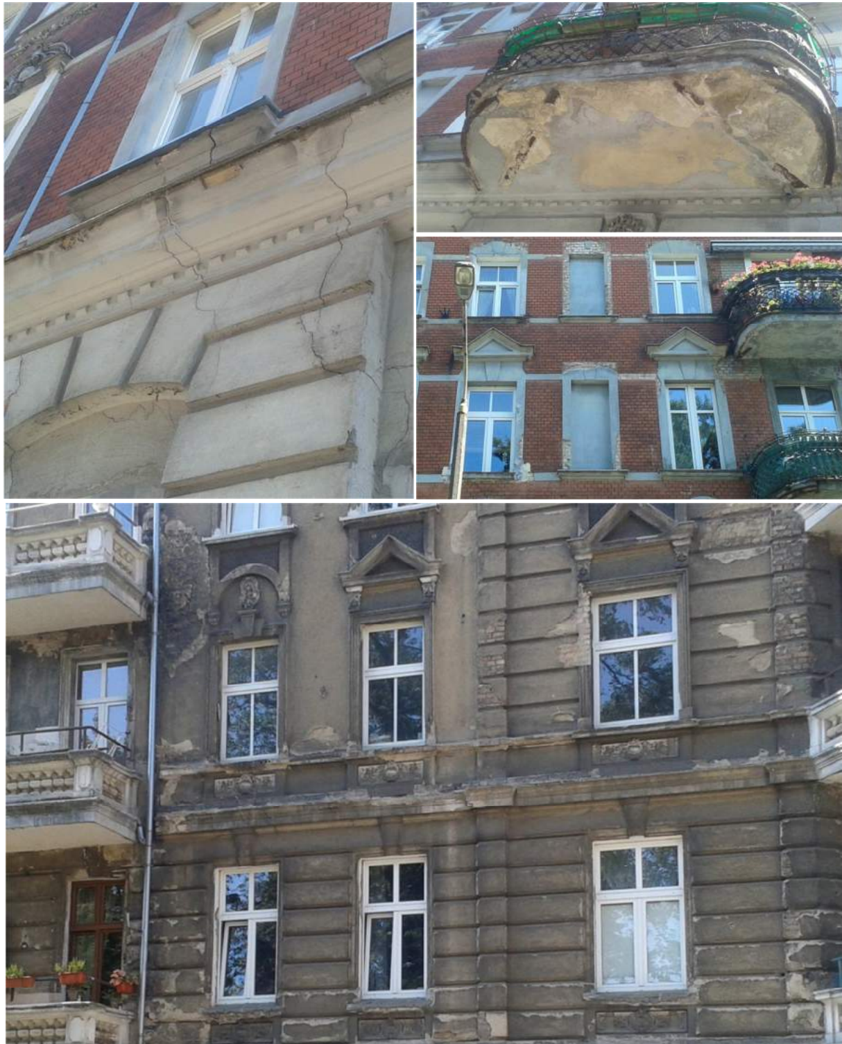
Ryc. 42. Faktyczny stan techniczny przykładowych budynków „w stanie dobrym”: przykład Łokietka 29 – prawdopodobnie konieczność natychmiastowego remontu kapitalnego
