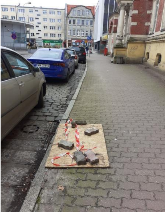
Rysunek 21 Zapadnięty chodnik ul. Pocztowa.
